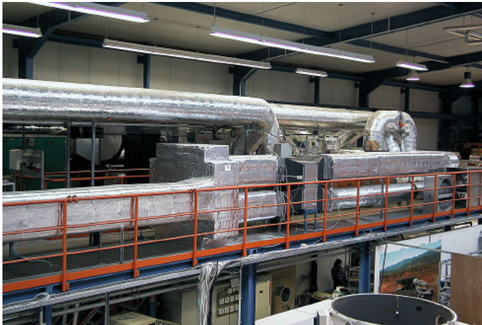
Abb. 52: Blick auf den Versuchsstand zur Optimierung des Sorptionsregenerators
