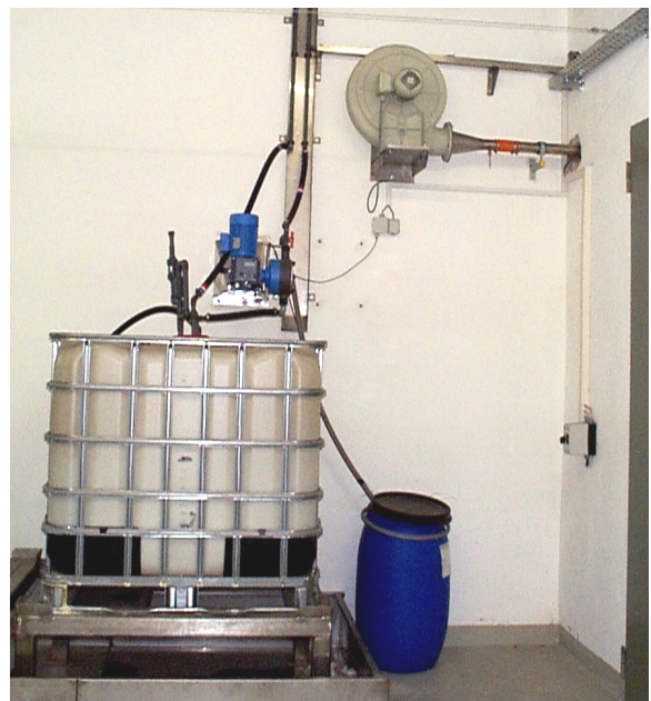
Bild 5-12: Säurelagerung und -dosierung
