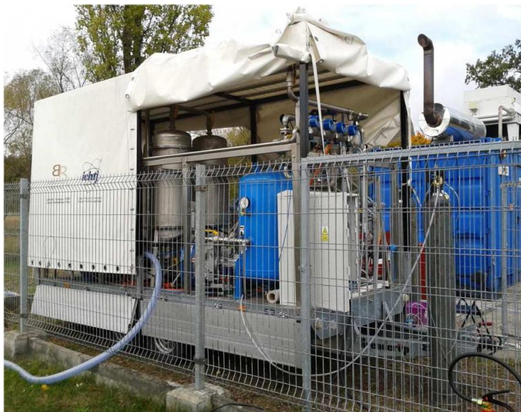
Rys. 1. Zdjęcie mobilnej instalacji membranowej podczas badań terenowych na składowisku odpadów komunalnych w Toruniu.
