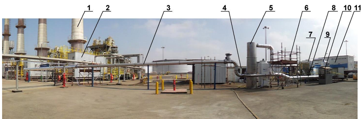
Rys. 3. Widok ogólny pilotowej instalacji oczyszczania spalin w Rafinerii Jeddah.
