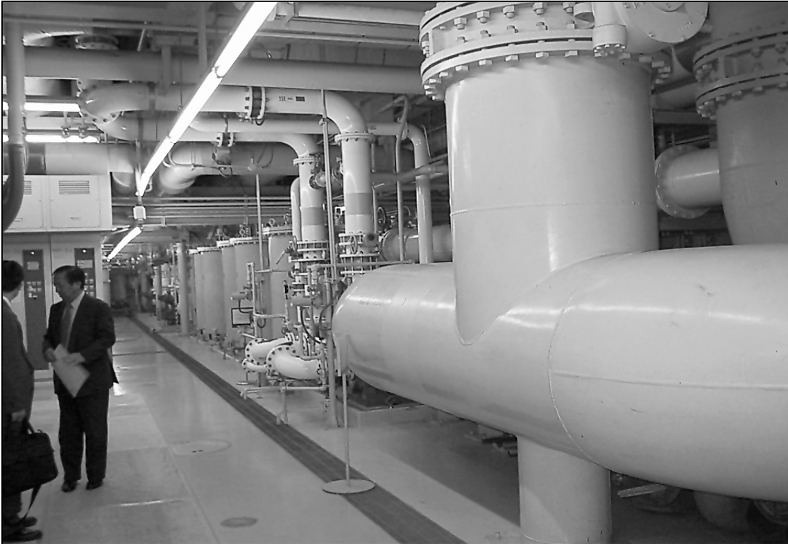
Abbildung 29: Brauchwasserverteilrohre der Nachbehandlungs- und Verteilstation Chiba
