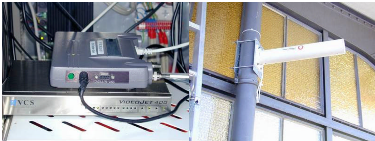
Abbildung: Bahnsteigseitige Komponenten der Funk-LAN-Strecke
