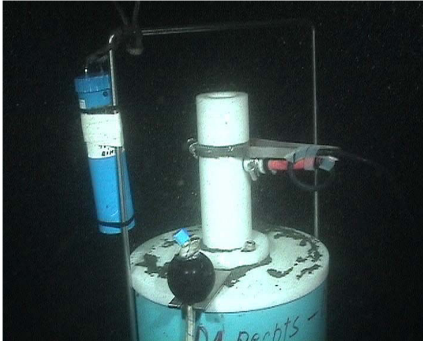
Abbildung 6: Unterwasseraufnahme vom Brunnenkopf mit der Strömungssonde, der Steuer-/Batterie-Einheit am Sicherungsbügel
