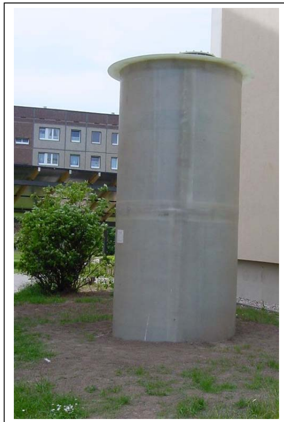
Abbildung 48: 5 m 3 Pufferspeicher in einer solarthermischen Anlage aus Solarthermie-2000, TP 2 (Förderkennzeichen 0329603) in Weißenfels
