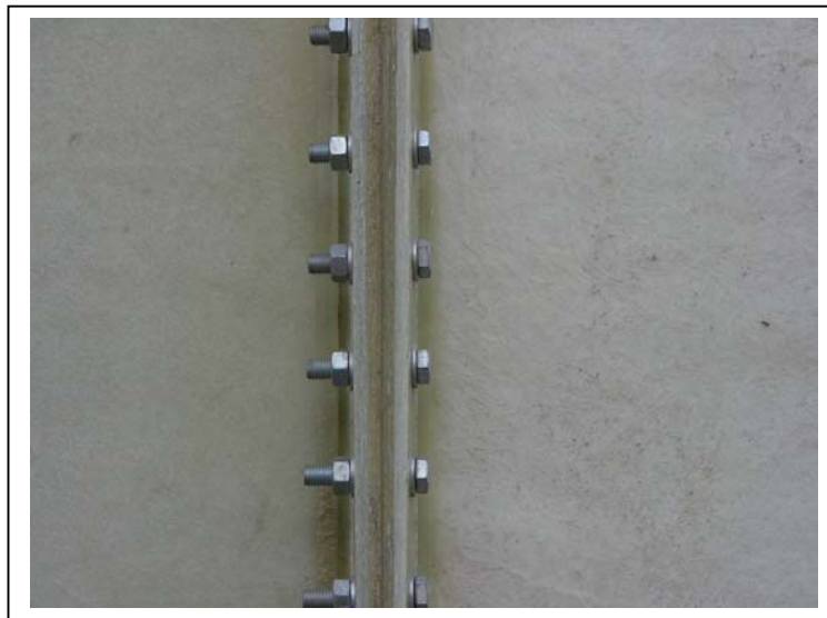
Abbildung 13: Schraubverbindungen am 300 m 3 Pilotspeicher im Detail
