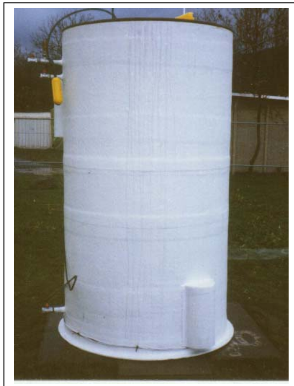
Abbildung 11: 1,3 m 3 Musterspeicher am Standort TU Ilmenau
