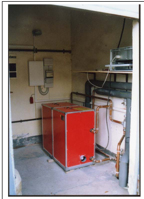
Abbildung 24: Wärmepumpen und Datenlogger im Technikraum des Pilotspeichers
