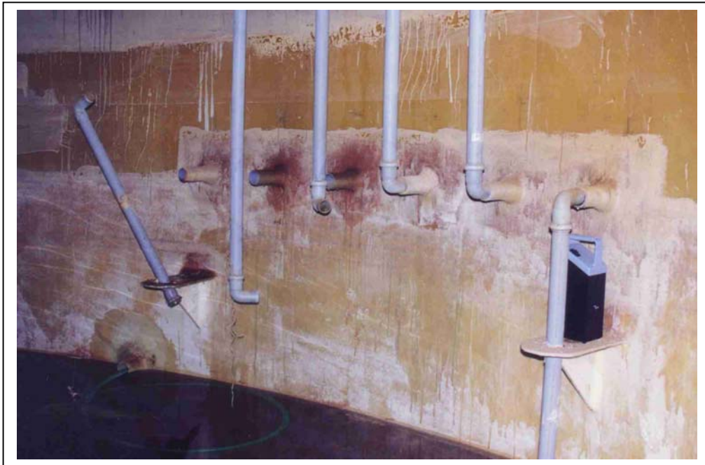
Abbildung 29: Revision des 300 m 3 Pilotspeichers; deutlich zu sehen sind die gelösten Rohrverbindungen
