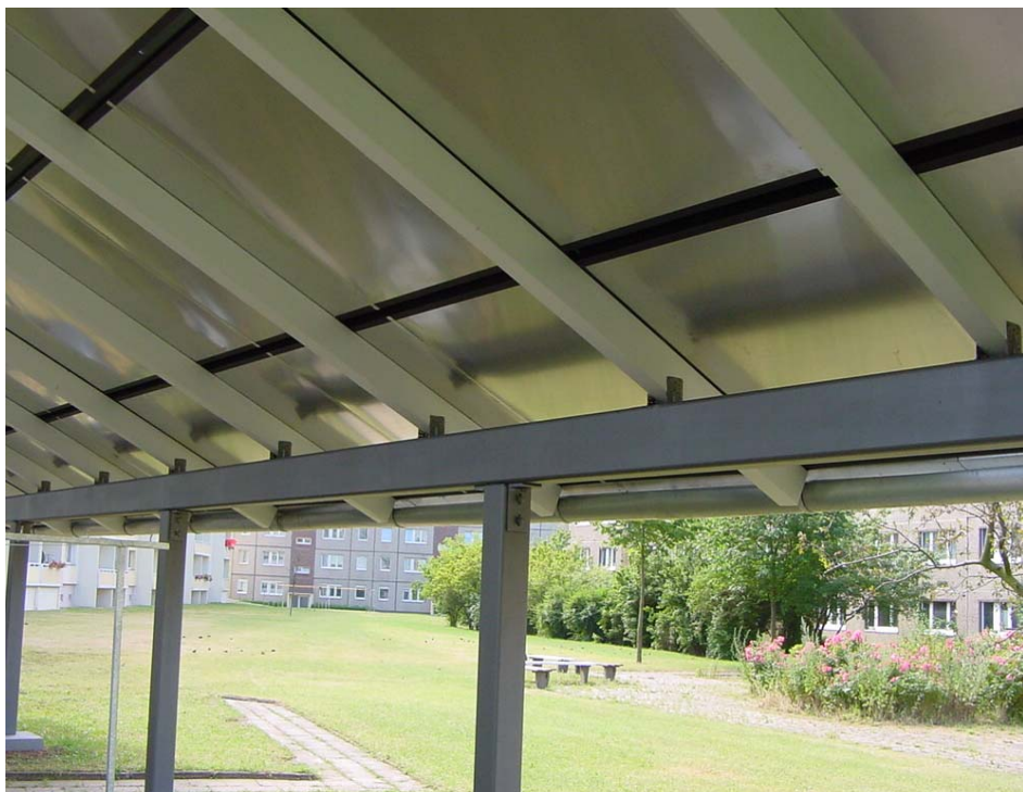
Solaranlage Weißenfels, Rückansicht
