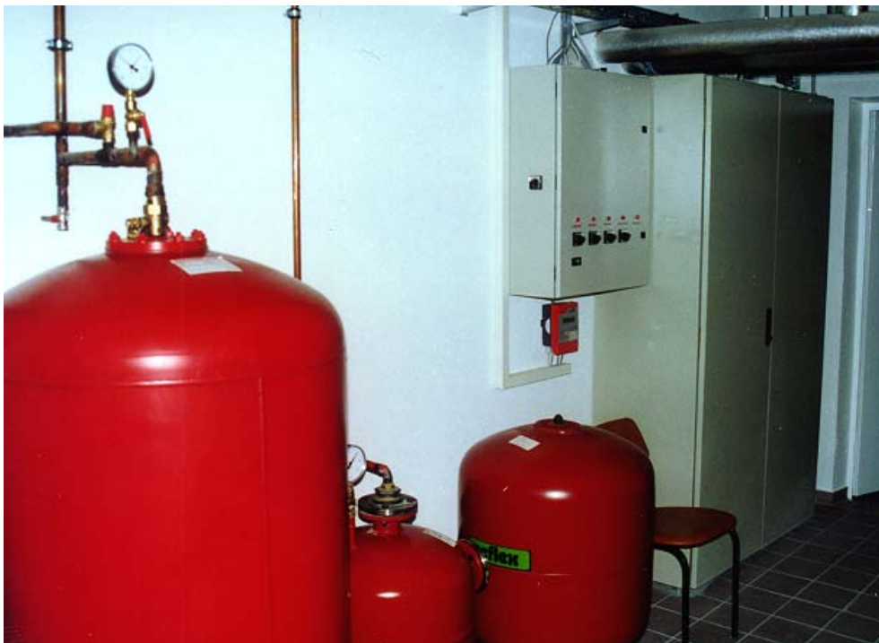
Ansicht des Kellerraumes mit den Ausdehnungsgefäßen, dem Anlagenschalt-schrank sowie dem Messtechnikschrank (Foto: TU I / FG TFD 01)
