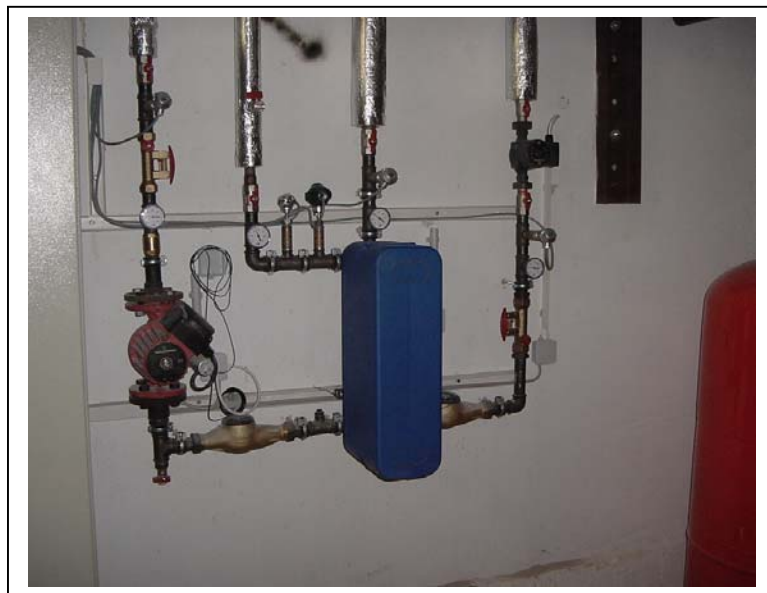
Solarstation, Wärmetauscher Kollektorkreis (Foto: TU I / FG TFD 02)
