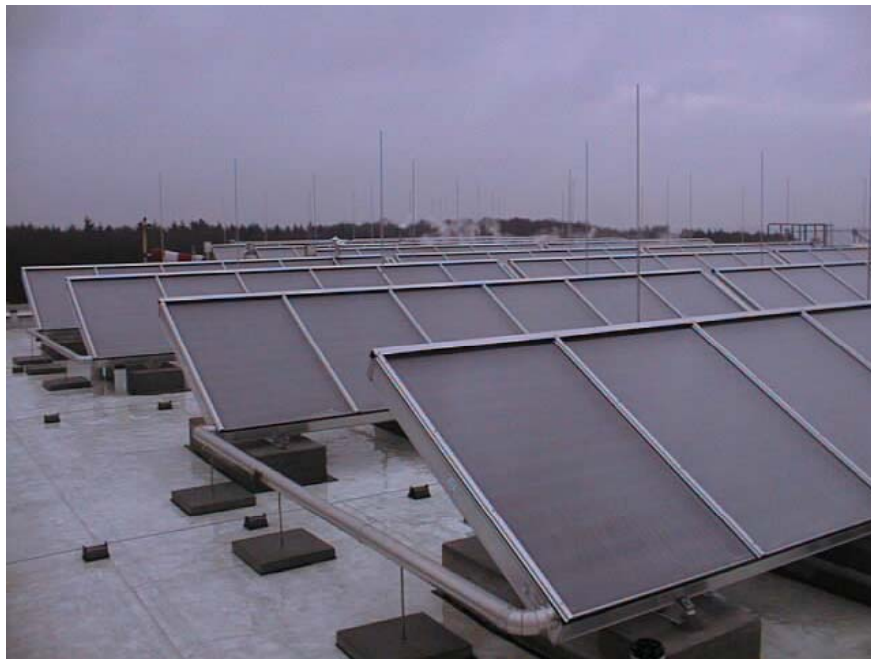
Ansicht des Westdaches mit 153m 2 Kollektorfläche. (Foto: TU I / FG TFD 2001)
