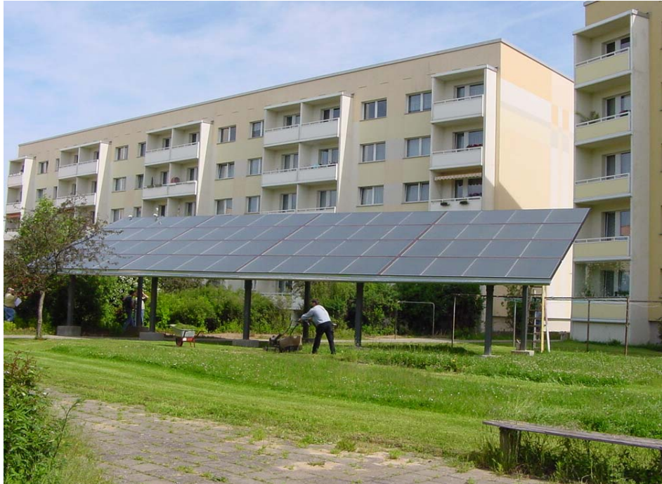
Solaranlage Weißenfels; Kollektorfeld
