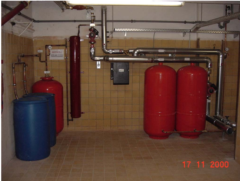
Ansicht des Solarsystems mit den beiden Ausdehnungsgefäßen des Pufferkreises (im Bild rechts). Hydraulisch vor dem Ausdehnungsgefäß des Kollektorkreises ist ein Vorbehälter montiert, der die thermische Belastung der Membran im Ausdehnungsgefäß verringern soll. (Foto: TU I / FG TFD 01)
