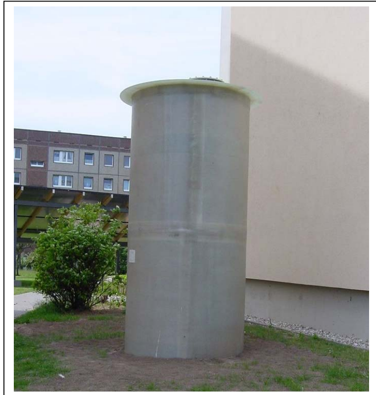
5 m 3 Pufferspeicher aus GFK-Verbundwerkstoff (Foto: TU I / FG TFD 02)
