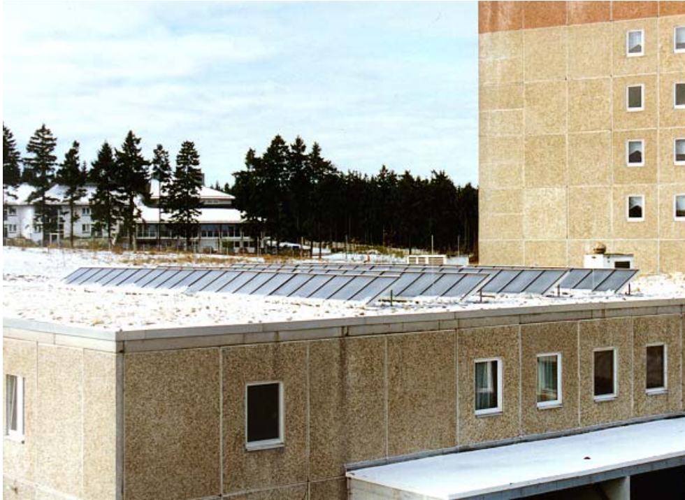
Ansicht des Kollektorfeldes auf dem Versorgungsgebäude des Kreiskrankenhauses Neuhaus am Rennweg ( Foto: TU I / FG TFD 01 )
