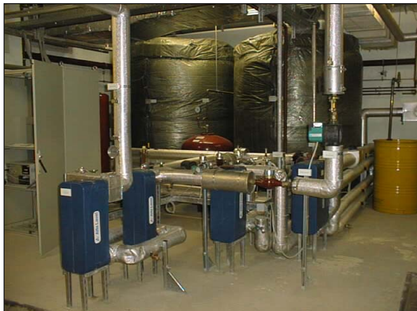
Ansicht des Solarsystems in der Technikzentrale des Hauses. (Foto: TU I / FG TFD 2001)
