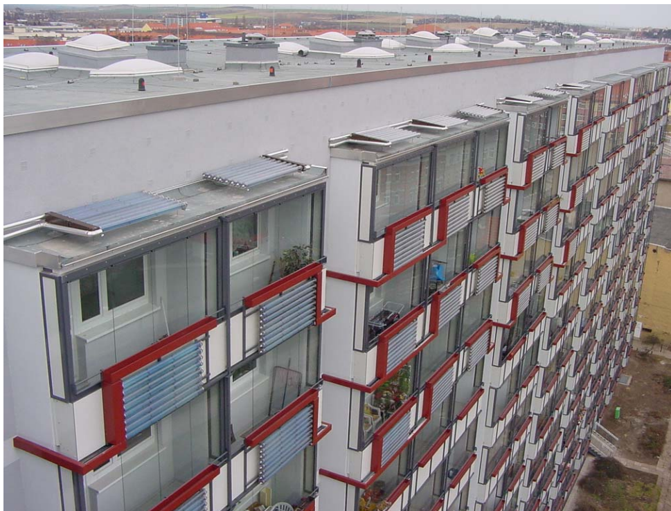
Teilansicht des Kollektorfeldes Gagarin-Ring 128. In den roten Verkleidungen ist die Verrohrung der Kollektoren untergebracht. Die Sammelleitungen der Stränge sind unter der Fassadenisolation nach oben in den Drempel geführt. ( Foto: TU I / FG TFD 01 )
