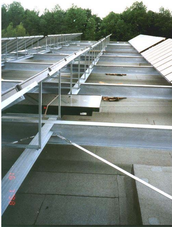
Abbildung: Detailansichten zum Kollektorfeld einschließlich Aufständering / Tragwerk
