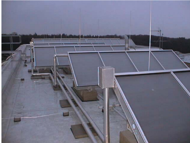
Ansicht des Ostdaches mit 50m 2 Kollektorfläche. (Foto: TU I / FG TFD 2001)
