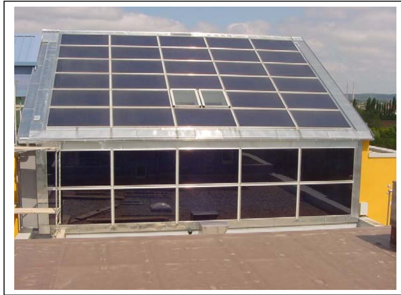
Solaranlage Gera, Kollektorfeld
