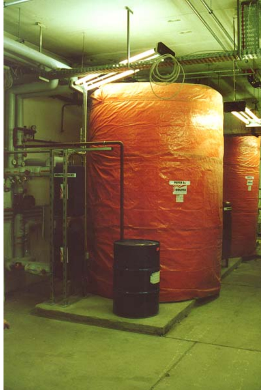
Ansicht der Pufferspeicher
