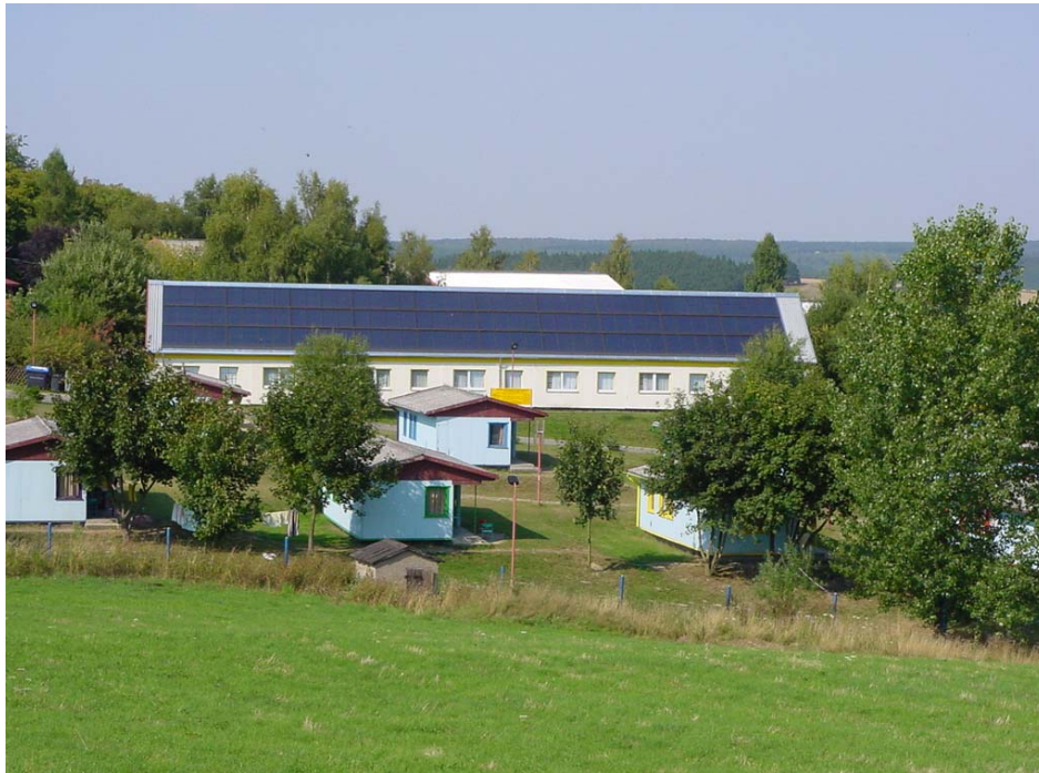
Gesamtansicht des Kollektorfeldes auf dem Dach des Bettenhauses 1, aus südlicher Richtung (Foto: TU I / FG TFD 01)
