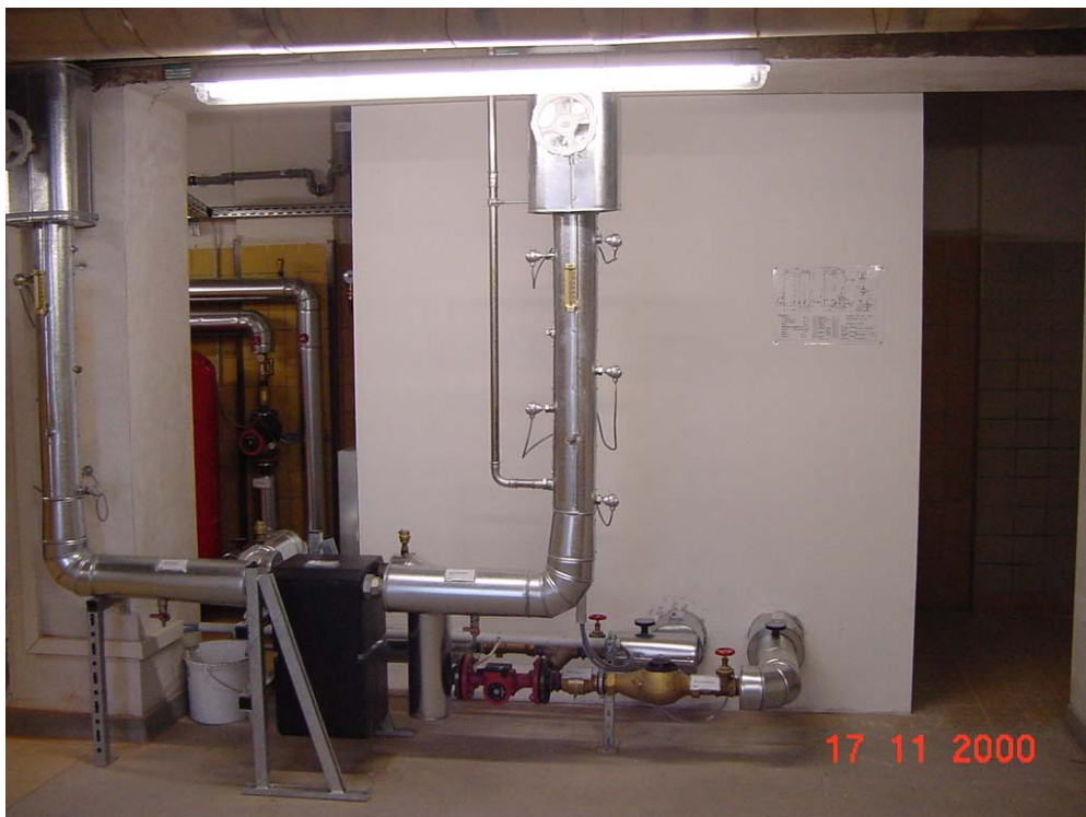
Ansicht des Pufferspeichers der Anlage im Haustechnikraum der Inneren Medizin (quadratischer kellergeschweißter Niederdruckspeicher, die Verkleidung des Isoliermantels besteht aus Gipskartonplatten) (Foto: TU I / FG TFD 01)
