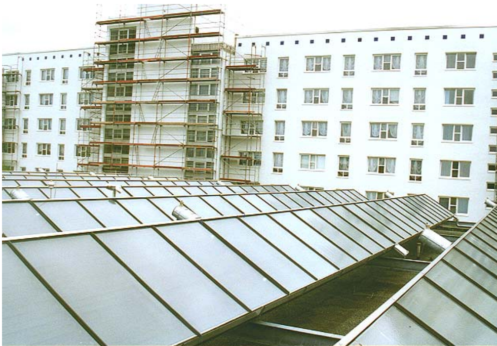
Teilansicht des Kollektorfeldes. Im Hintergrund ist das Bettenhaus/Wohnheim des Alten- und Pflegeheimes zu sehen
