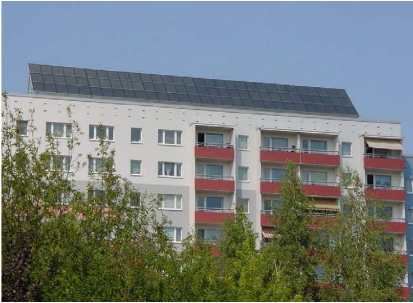
Solaranlage Weimar; Kollektorfeld
