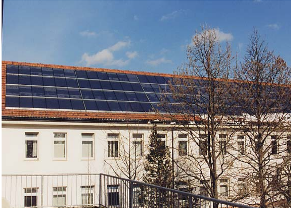
Gesamtansicht des Kollektorfeldes auf dem Dach der Inneren Medizin (Foto: TU I / FG TFD 01)
