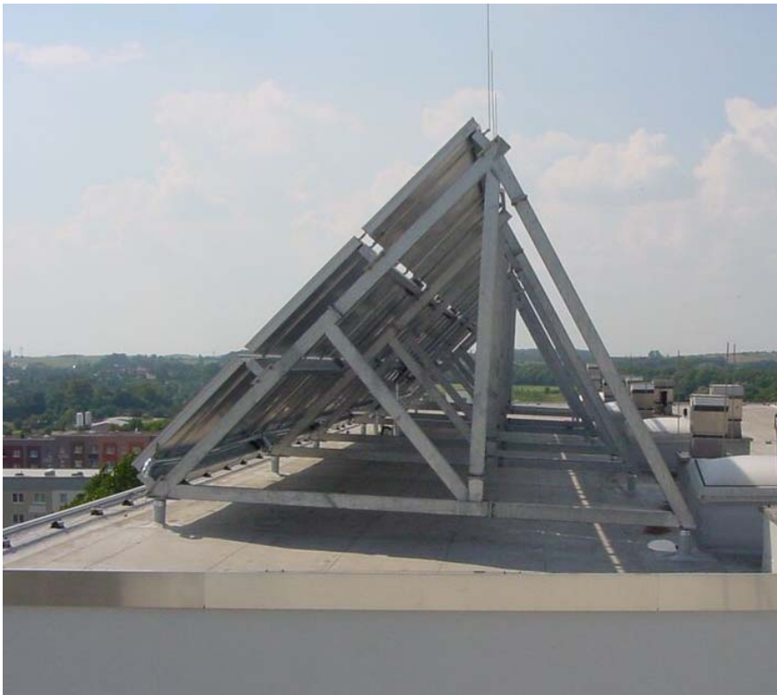
Solaranlage, Seitenansicht des Kollektorfeldes
