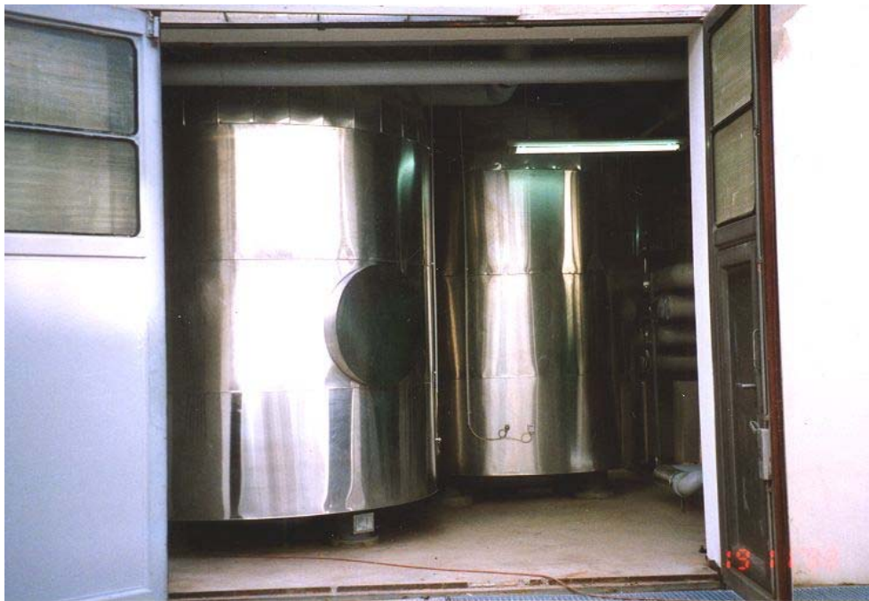
Abbildung Ansicht der isolierten Solarpufferspeicher (2x 17,4 m 3 Speichervolumen) im Technikraum der Technischen Versorgung.
