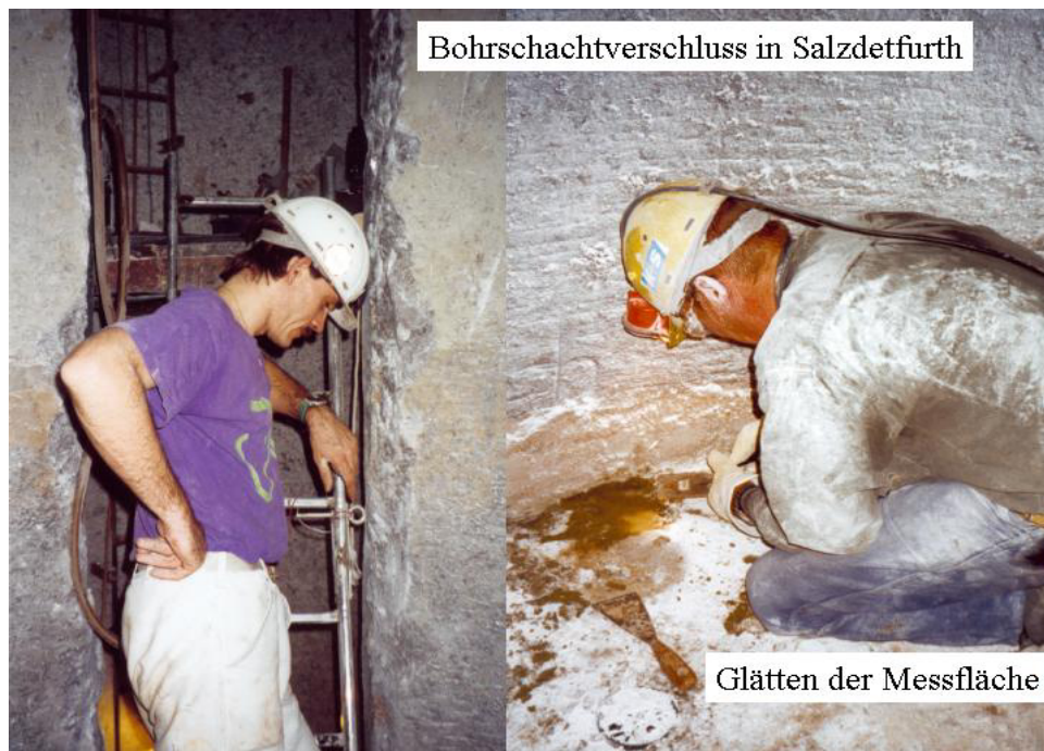
Bild 4.1 Durchfeuchtete Stellen in einem Bohrschachtverschluss in Salzdetfurth
