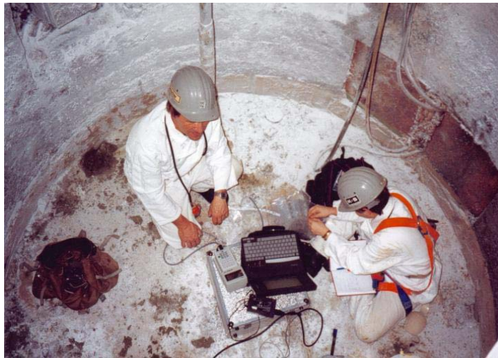
Bild 4.5 Messstation am Boden des Bohrschachtverschlusses
