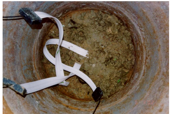
Bild 18 untere Bentonitschicht (Kissen) komplett durchfeuchtet
