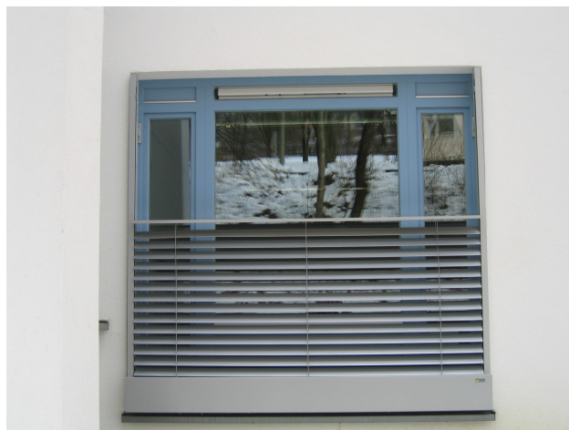
Bild 5.16: Außenansicht des externen Sonnenschutzes der Büroräume.
