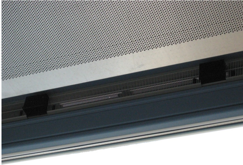
Bild 5.9: Zuluftöffnungen der Büroräume
