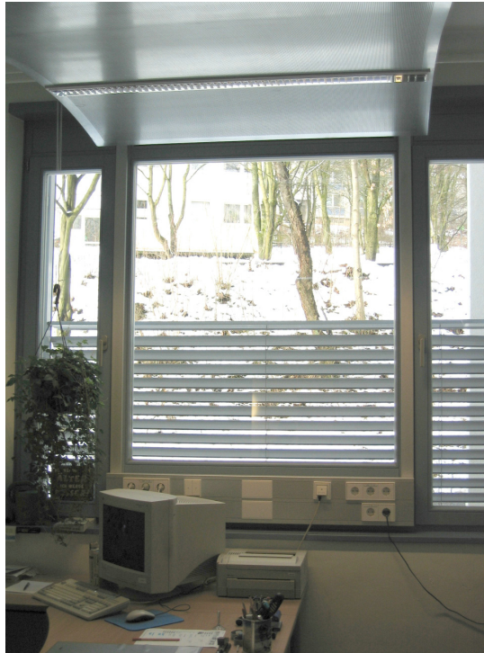
Bild 5.15: Von unten nach oben schließender externer Sonnenschutz der Büroräume.
