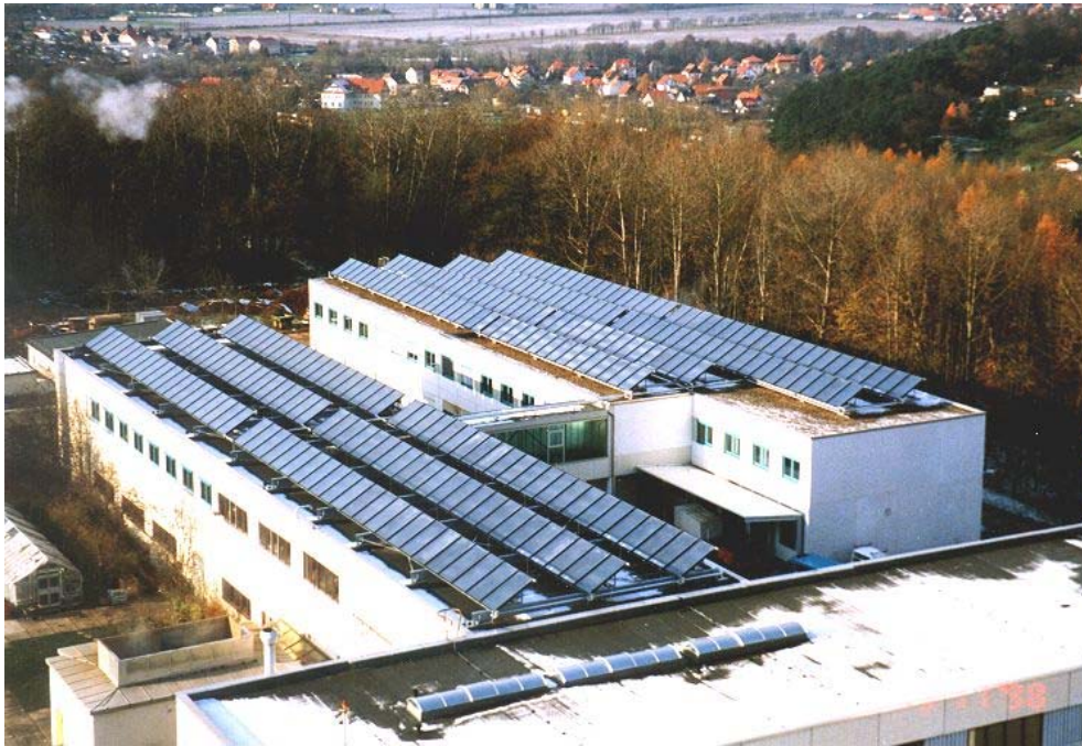
Gesamtansicht des Kollektorfeldes auf dem Dach der Technischen Versorgung und der Apotheke.
