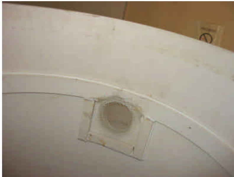
Abbildung 6: Schutz gegen Eindringen von Mosquitos am Überlauf eines dezentralen Regenwasserspeichers.
