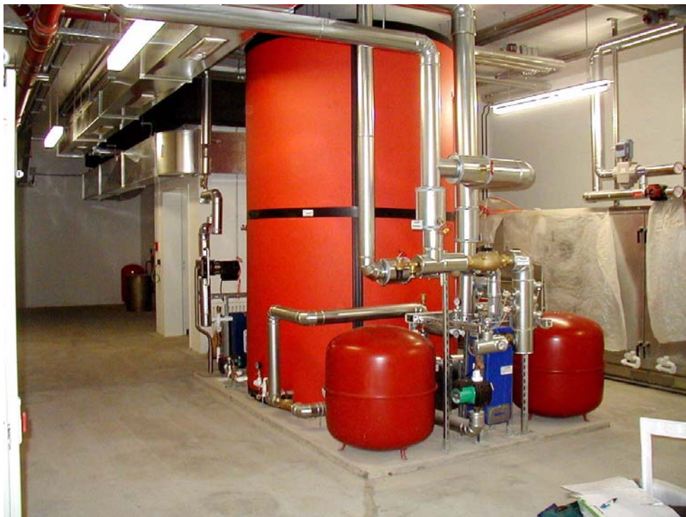
Abb. Speicheransicht und Solartechnik im Keller (Foto: TU Ilmenau FG TFD 2001)
