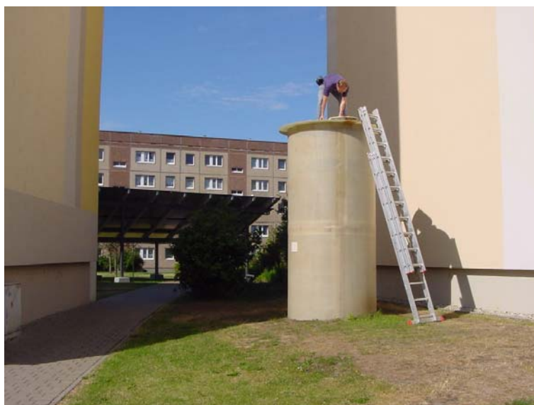
Abb. Ansicht des Pufferspeichers der Anlage (Foto: TU I 2002)
