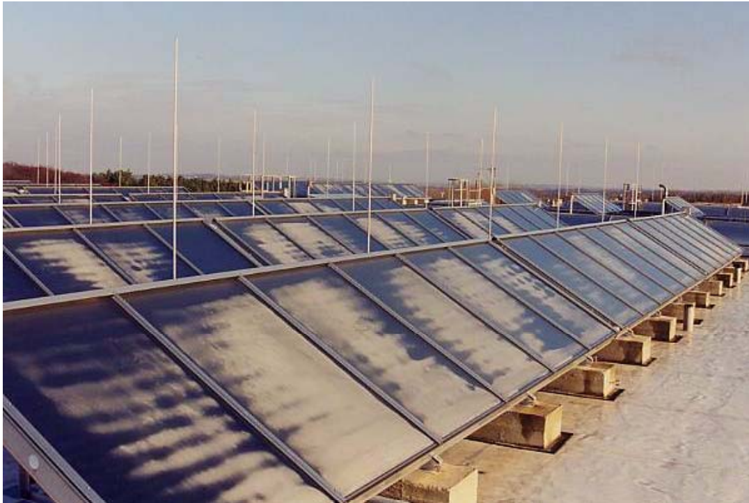
Abb. 11 Ansicht des Kollektorfeldes (Quelle: Foto: TU I / FG TFD 2000)
