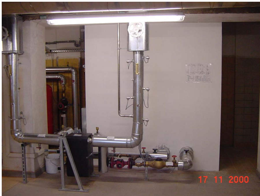
Abb. Ansicht des Pufferspeichers der Anlage im Haustechnikraum der Inneren Medizin (quadratischer kellergeschweißter Niederdruckspeicher, die Verkleidung des Isoliermantels besteht aus Gipskartonplatten) (Foto: TU Ilmenau FG TFD 2001)
