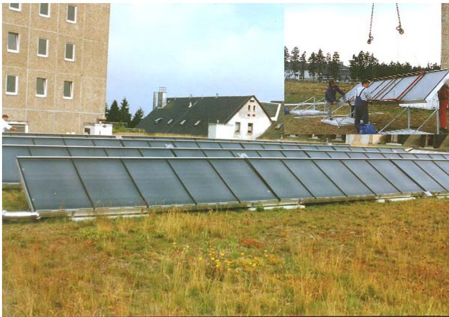
Abb. Ansicht des Kollektorfeldes (kleines Bild: Kollektormontage) (Foto: TU Ilmenau FG TFD 2000)
