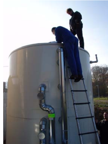
Abb. 22 15 m 3 -GFK Wärmespeicher (Quelle: Foto J. Bühl Ilmenau 2006)
