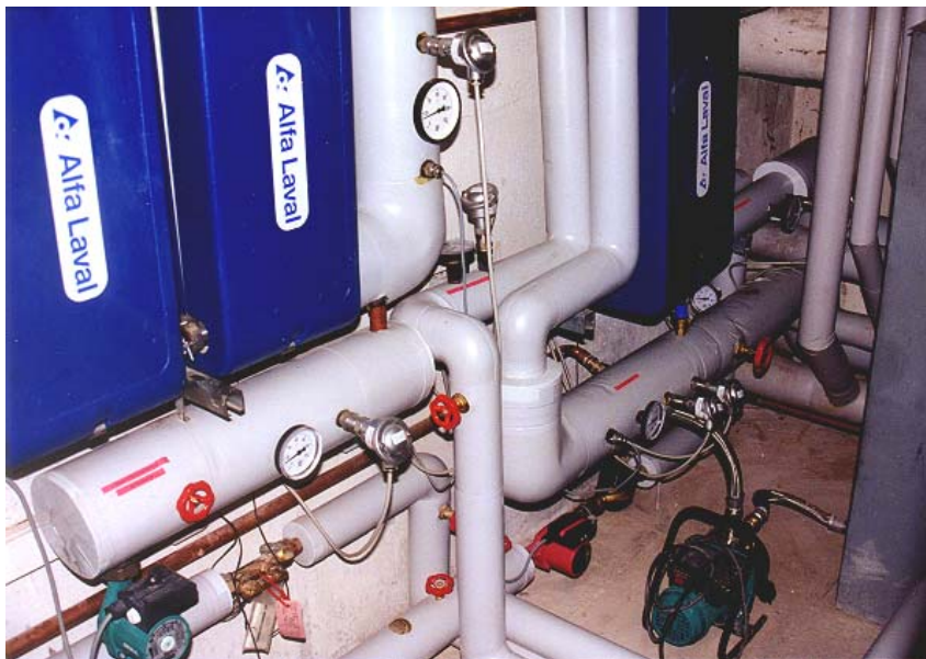
Abb. Detailansicht der Solartechnik im Keller (Technikraum / Wärmetauscher) (Foto: TU Ilmenau FG TFD 2000)
