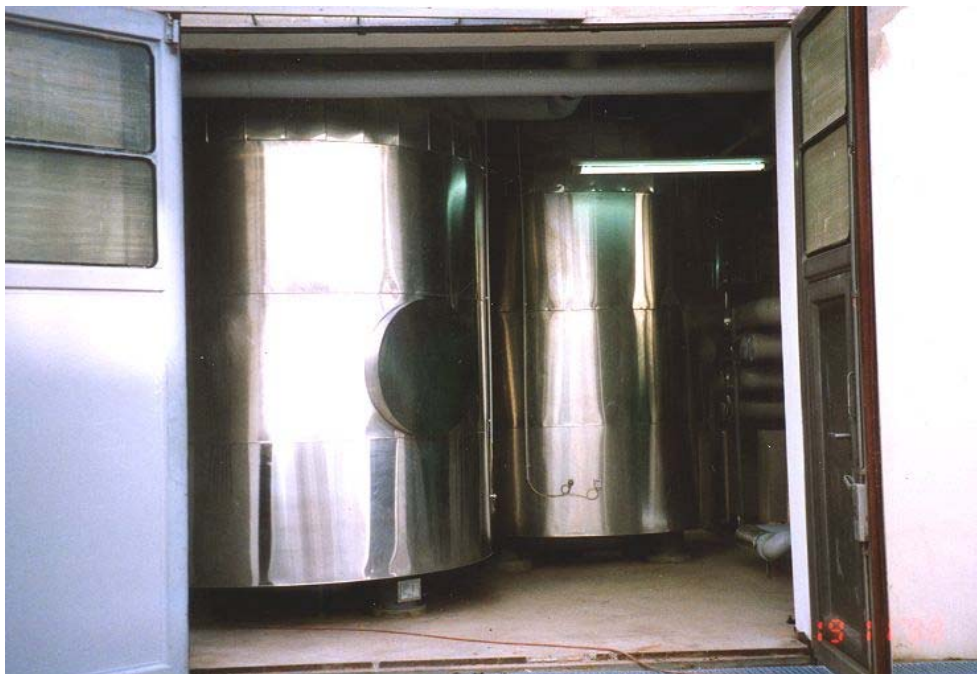
Abb. Ansicht der isolierten Solar-Pufferspeicher im Technikraum der Technischen Versorgung (Foto: TU I / FG TFD 01 mit freundlicher Genehmigung durch Ing.-Büro für Licht- und Solartechnik Sondershausen)
