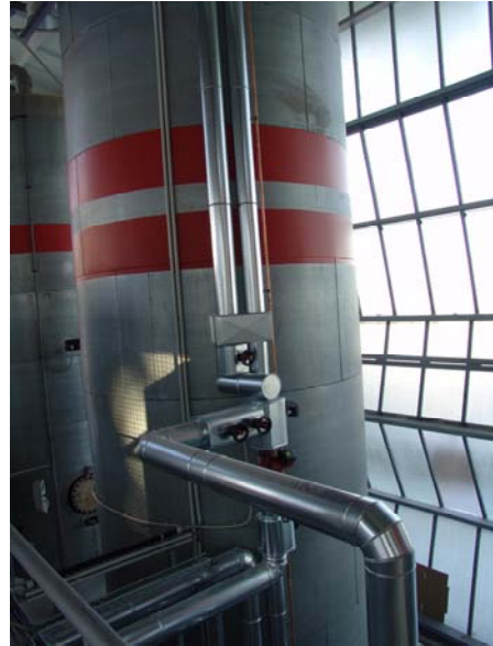
Abb. 20 Ansicht Pufferspeicher (2x 50 m 3 ) (Quelle: Foto J. Bühl Ilmenau 2006)
