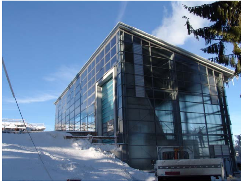
Abb. Ansicht des Heizhauses – Im Bild links ist das in die Fassade integrierte Kollektorfeld zu sehen (Foto: J. Bühl Ilmenau 2006)
