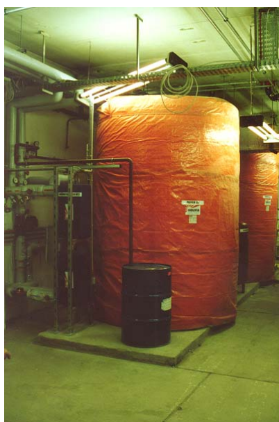
Abb. Solarspeicher (2 x 1) im Keller (Foto: TU Ilmenau FG TFD 2000)
