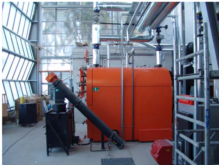
Abb. Biomassekessel im Heizhaus (Foto: J. Bühl Ilmenau 2006)
