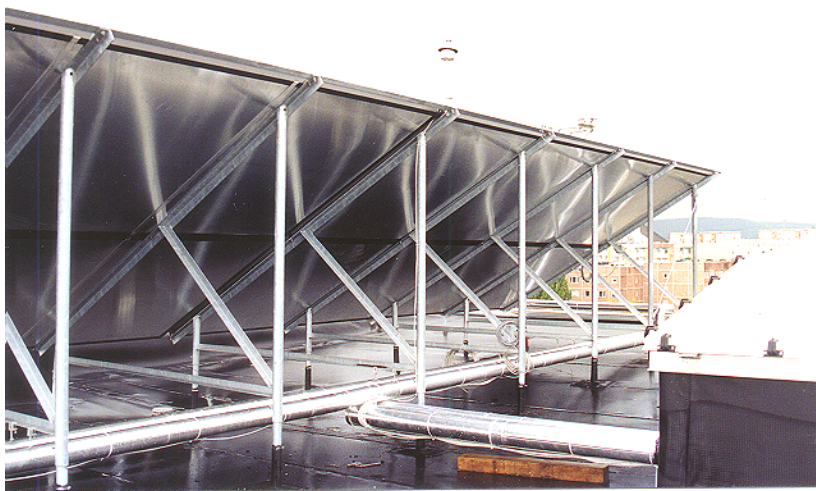
Abb. Detailansicht des Kollektorfeldes und der -Aufständering (Foto: TU Ilmenau FG TFD 2000)
