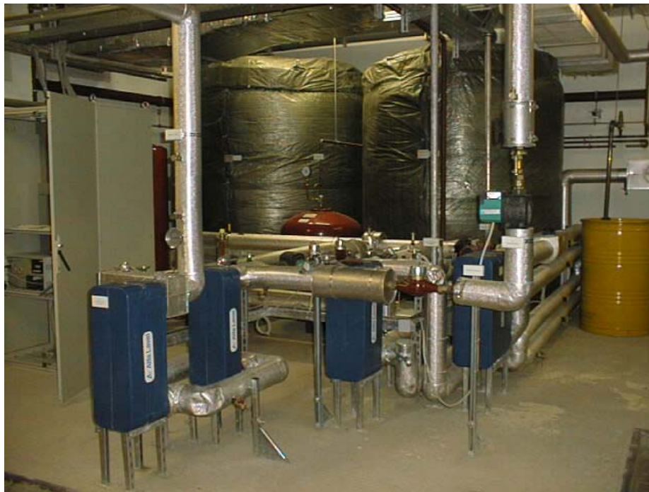
Abb. Ansicht in der Technikzentrale des Hauses (Foto TU Ilmenau FG TFD 2000)
