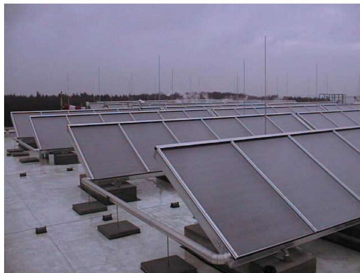
Abb. Ansicht des West-Daches mit 153 m 2 Kollektorfläche (Foto TU Ilmenau FG TFD 2000)
