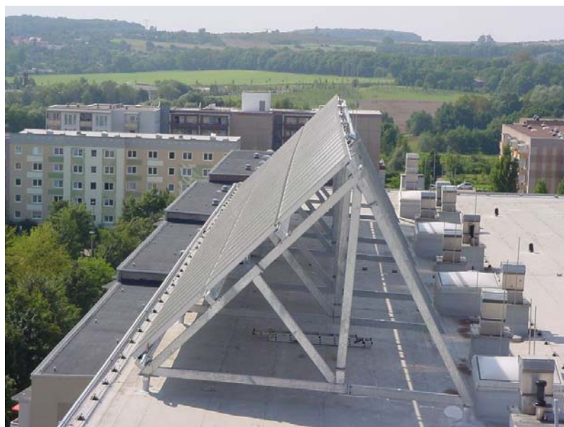
Abb. Die Kollektoren sind auf einer Stahlkonstruktion aufgeständert. Die Neigung beträgt 45 Grad. (Foto J. Bühl Ilmenau 2002)
