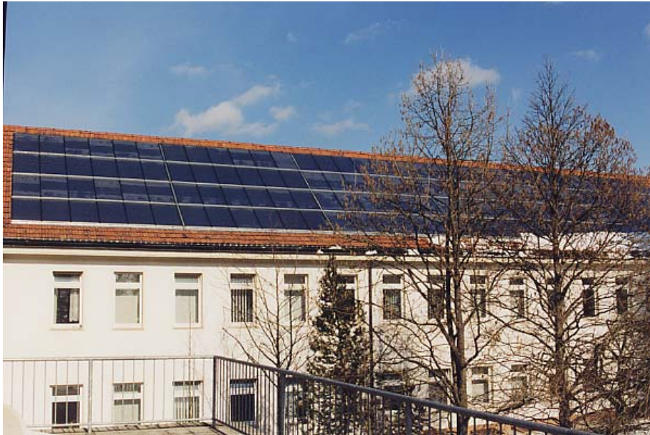
Abb. Gesamtansicht des Kollektorfeldes auf dem Dach der Inneren Medizin (Foto: TU Ilmenau FG TFD 2001)
