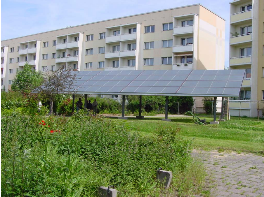
Abb. Ansicht des Kollektorfeldes aus südsüdöstlicher Richtung. Im Hintergrund ist eines der am System angeschlossenen Wohngebäude zu sehen. Der Pufferspeicher steht, im Bild nicht sichtbar, im Durchgangsbereich zwischen den beiden Gebäuden. (Foto: J. Bühl Ilmenau 2002)
