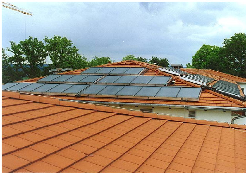
Abb. 07 Teilansicht der Kollektorfelder (Quelle: Foto: TU Ilmenau , FG TFD 1998)
