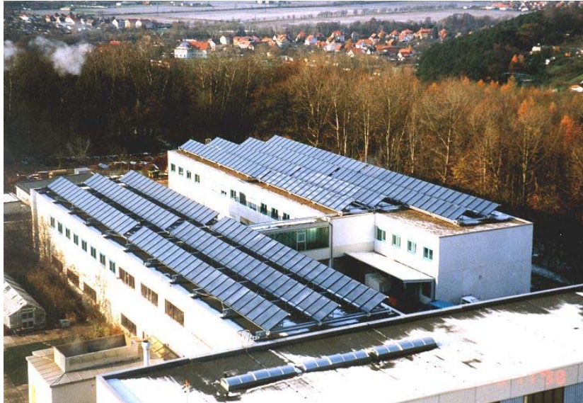
Abb. 10 Ansicht der Kollektorfelder (Quelle: TU I / FG TFD mit freundlicher Genehmigung durch Ing.-Büro für Licht- und Solartechnik, Sondershausen)
