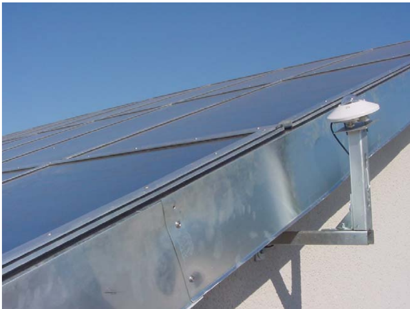
Abb. Teilansicht mit Konstruktionsdetail Strahlungsmessung in der Kollektorebene (Foto: J. Bühl Ilmenau 2006)
