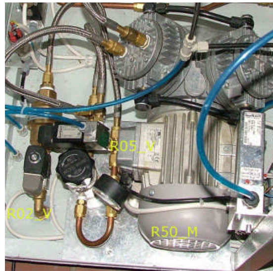
Abbildung 47: Gaseinlassventile und Kompressor
