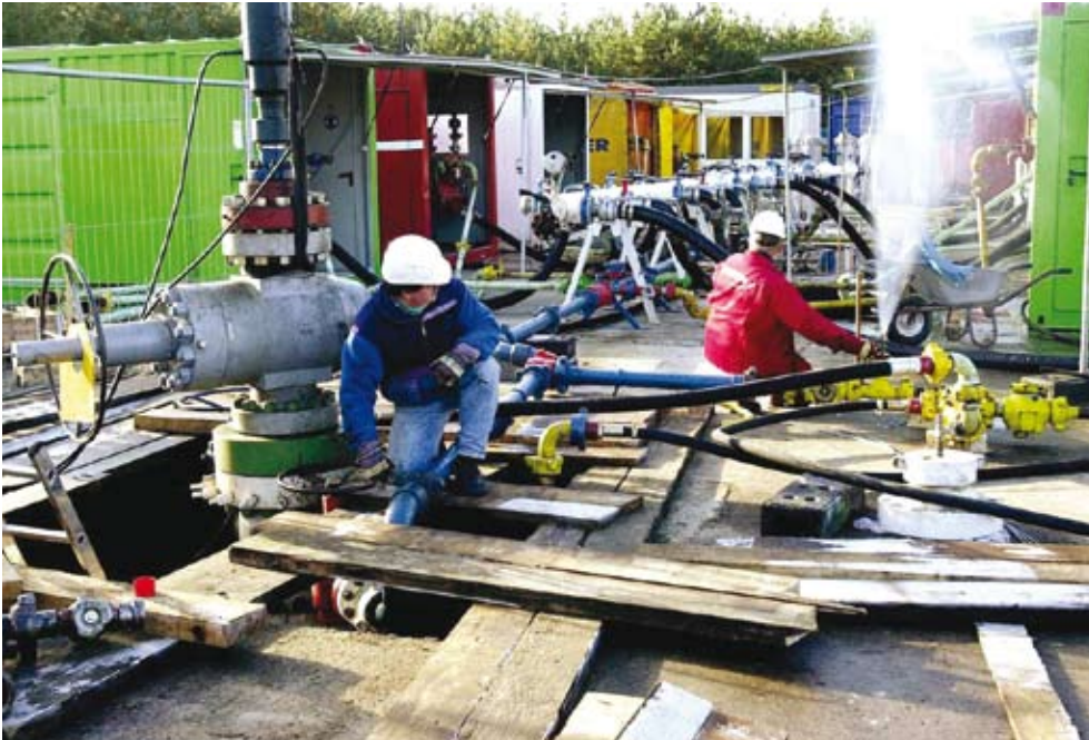
Abb. 15: Pumpenanlage beim Fractest
