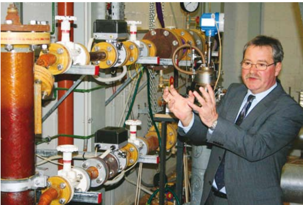
Abb. 31: In der Heizzentrale Neustadt-Glewe
