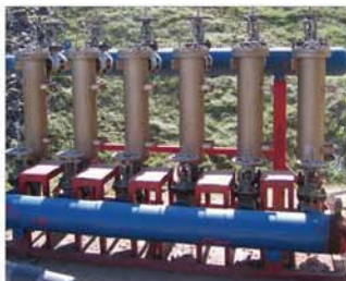
Filteranlage in Modulbauweise
