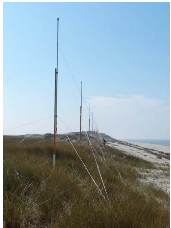
Fig. 2: Antennenanlage auf Sylt
