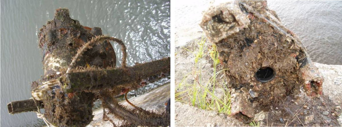
Abb. 18-19: Bewuchs auf der oberen (links) und der unteren (rechts) Zulaufpumpe
