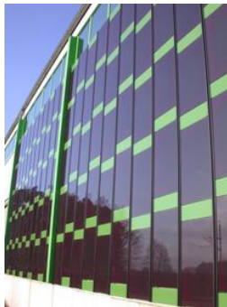
Abbildung 13: Gebäudeintegrierte Photovoltaik – (www.glaswerke-arnold.de)
