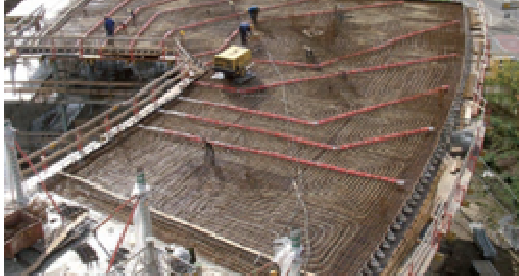
Abbildung 37: Betonkernaktivierung in der Geschosdecke eines Bürogebäudes ( www.hannover.ihk.de )
