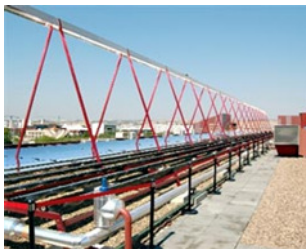
Abbildung 34: Fresnel-Prozesswärmekollektor auf dem Dach der Universität Sevilla (PSE AG)
