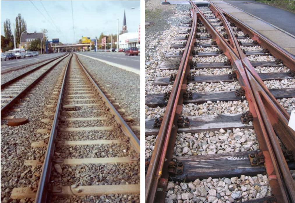
Abbildung 12: Einbauten in Gleisen (links), Querschnittsveränderungen im Bereich von Gleiswechselln (rechts)
