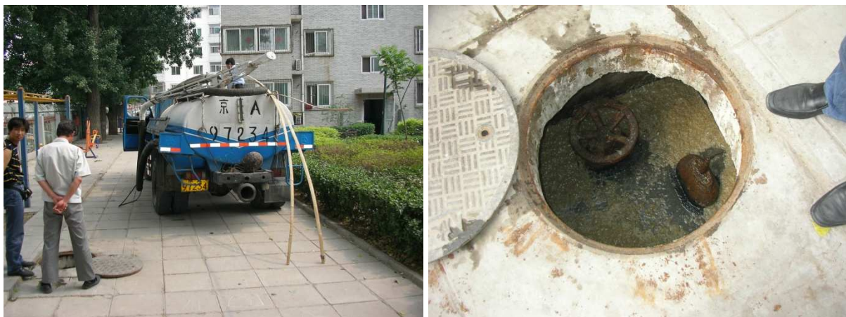
Abbildung 2 Tankwagen zum entleeren und Spülen des Septic tanks (links) Revisionschacht Hauptsammler mit Absperrventil überflutet (rechts).
