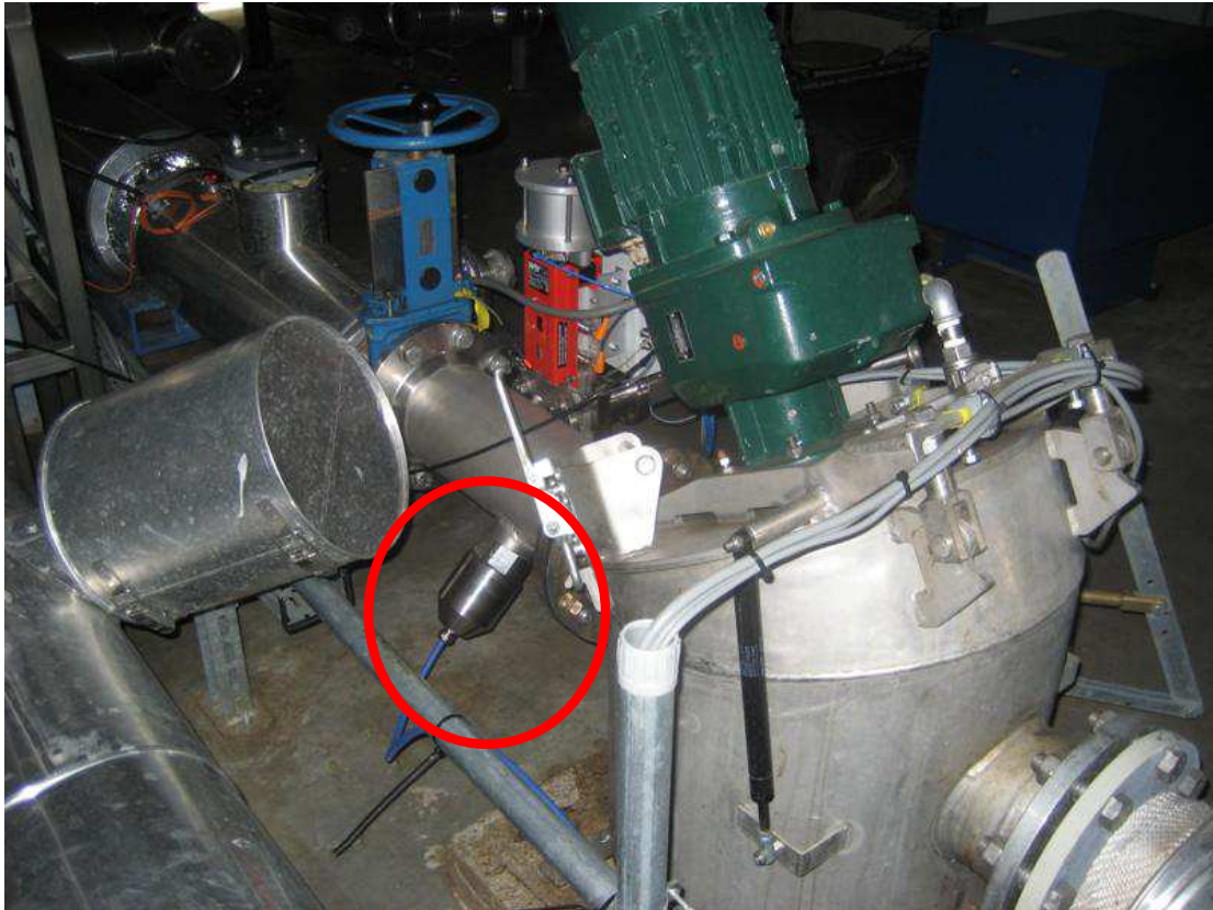
Abbildung 29: Installierter Messkopf im Abzug des Fermenters [eigene Darstellung]
