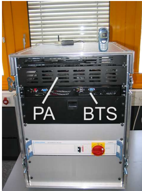
Abbildung 24: Realisierung der Basisstation
