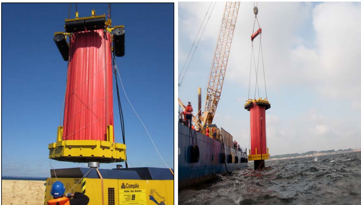
Abbildung 14: Menck Feuerwehrschauchsystem beim Abheben vom Deck der Arbeitsplattform (links) sowie bei der Installation am Pfahl (rechts) (Foto: Patrice Kunte)
