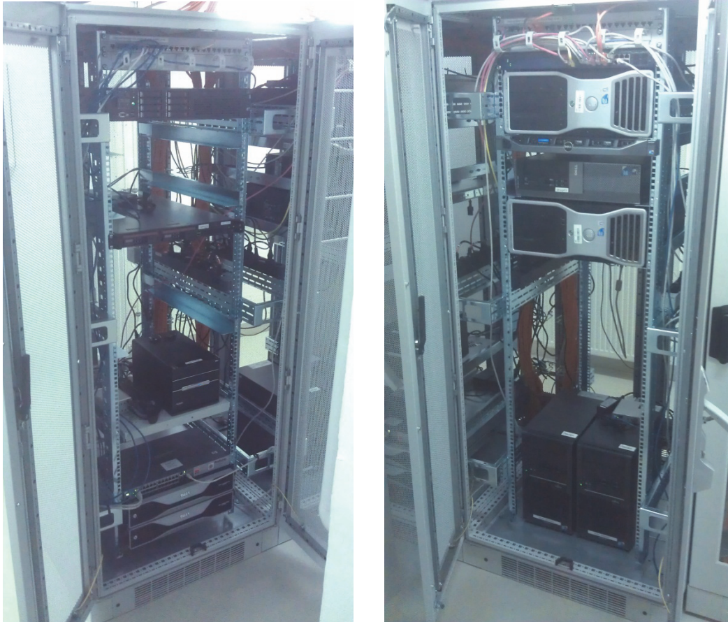
Abbildung 25: Rüstraum mit Serverschränken für Partnersysteme
