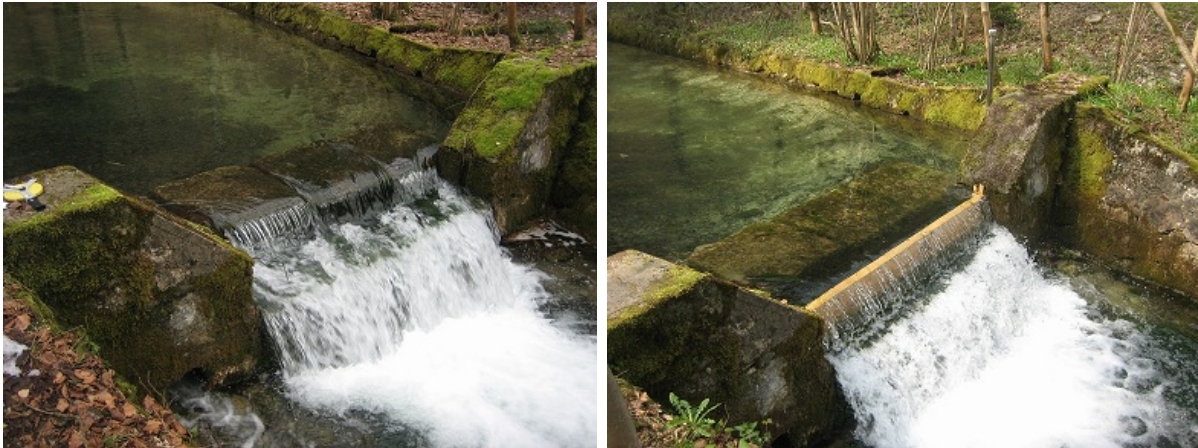
(a) Pegel Messwehr (vorher)
