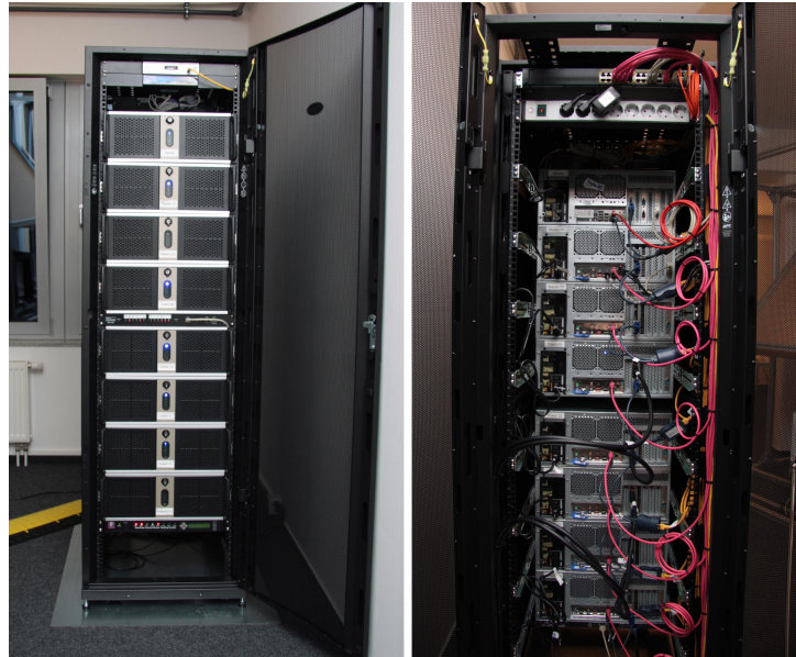
Abbildung 43: Serverschrank, Vor- und Rückansicht
