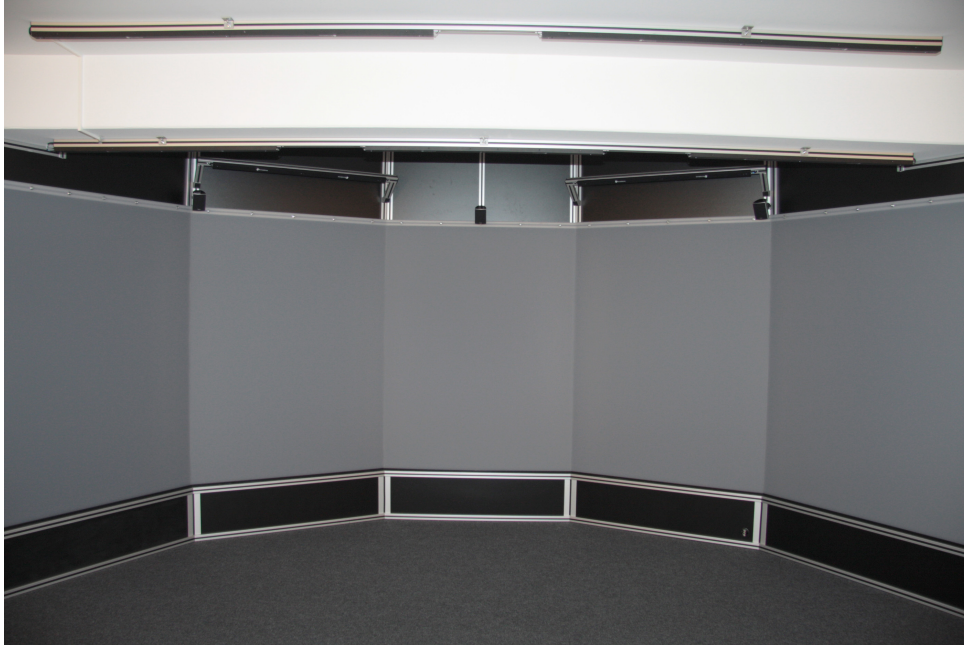
Abbildung 42: Arbeitsbereich der fertig montierten und verkleideten Stereo-Mehrfachprojektion
