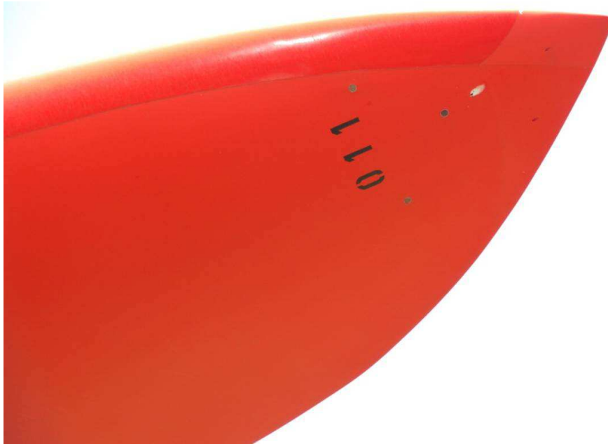
Abb. 5.2.2: Rotorblatt nach dreijährigem Betrieb mit Erosionsschutzfolie
