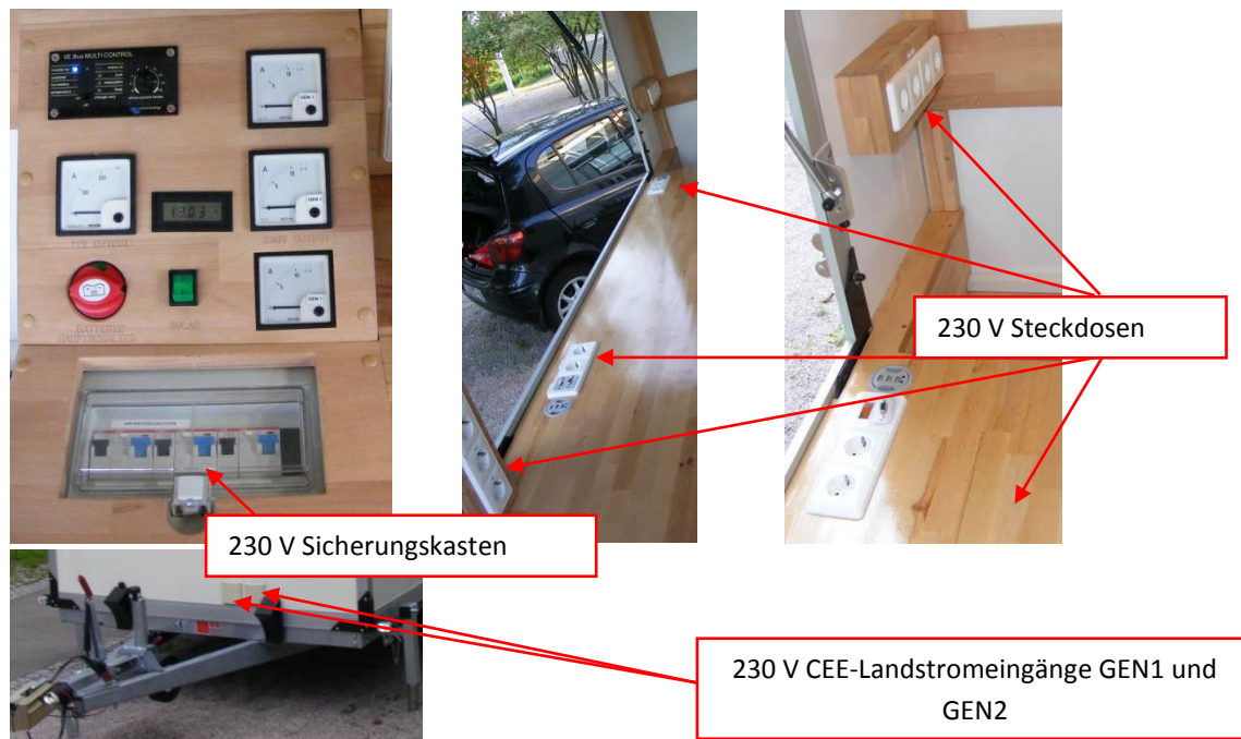
Abb. 55 Einige Beispiele der 230V Installation
