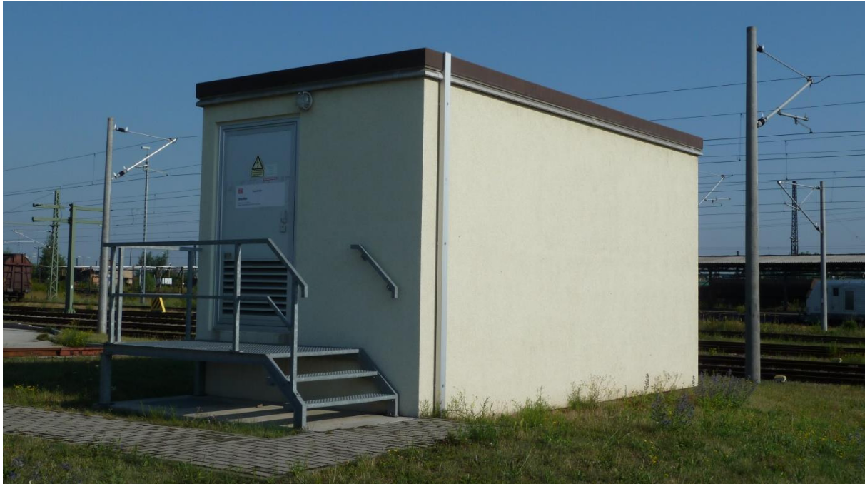
Abbildung 5: Ermittlung der neuralgischen Punkte im GVZ Dresden, hier z.B. ein Teil der Energieversorgung
