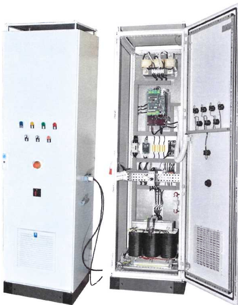
Abbildung 20: Versorgungsstation, Frontansicht und geöffnet
