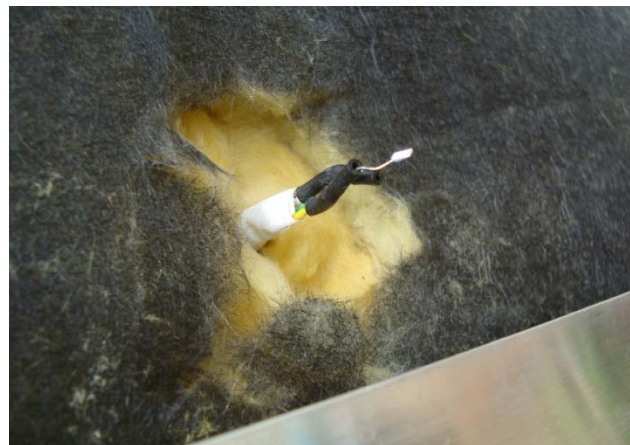
Abbildung 7-28: Selbst gebauter Temperaturfühler angebracht im Hinterlüftungsraum der PV-VHF
