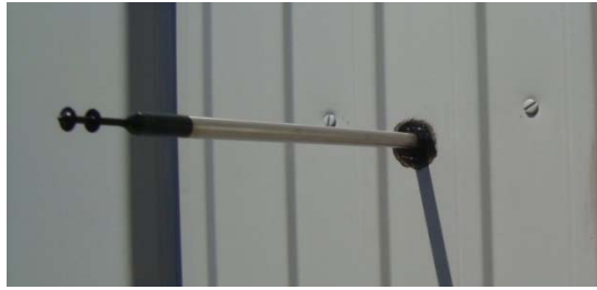
Abbildung 7-22: Strömungssensor SS 20.250 von Schmidt Technology montiert an der südlichen Außenwand des Freibewitterungsteststands
