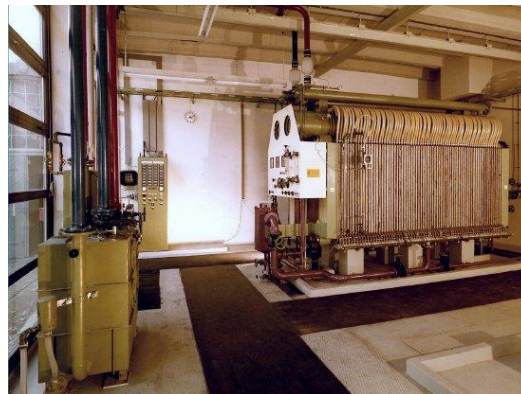
Abbildung 1-13: Atmosphärischer Elektrolyseur nach dem System BAMAG [ELT 1, 2014]
