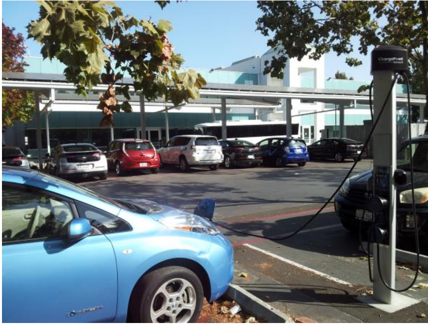
Abbildung 3: Google Mitarbeiterparkplatz mit Ladesäule
