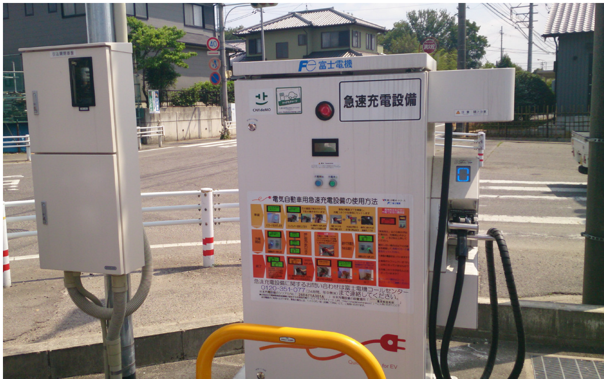
Abbildung 5: Öffentliche Schnellladestation auf einem "7eleven" Supermarktparkplatz
