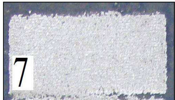
Bild 27: Delamination bei F+7
