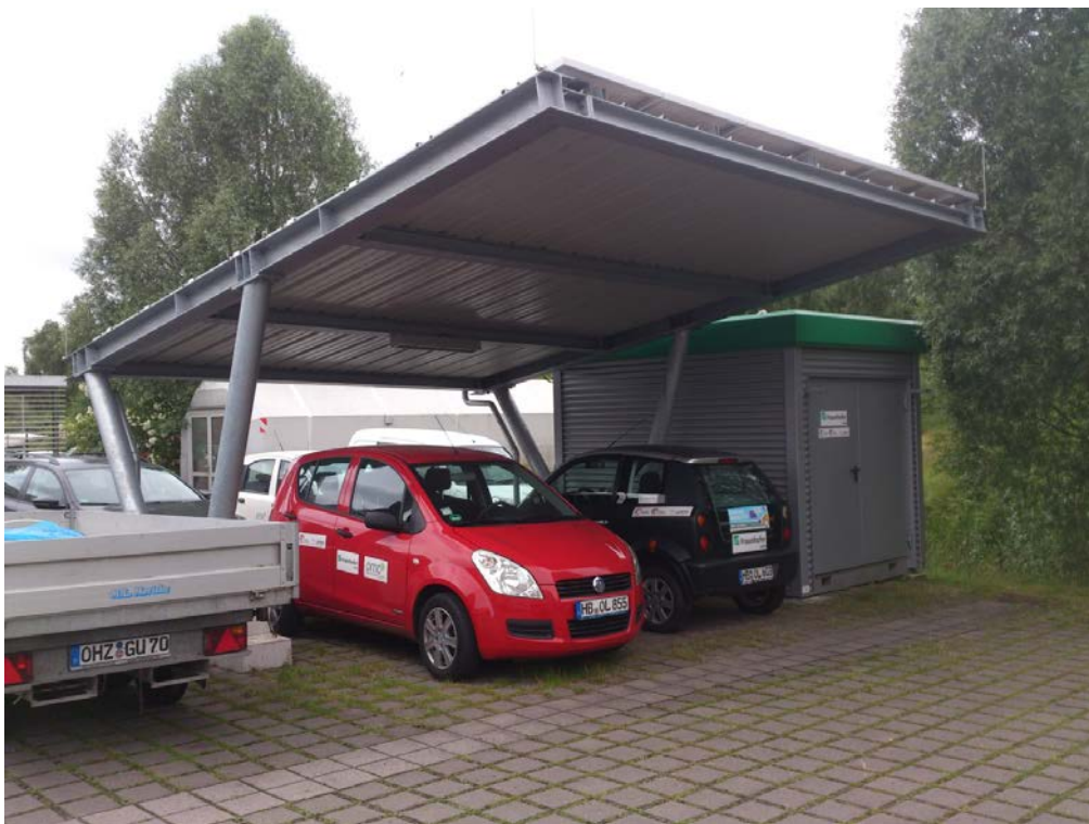
Abbildung 18: Außenansicht auf gesamte Anlage: Carport mit Solaranlage und 2nd Life Batteriecontainer.
