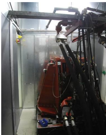
Abbildung 4: Antriebskammer und Trennwand mit Schallabsorbieren
