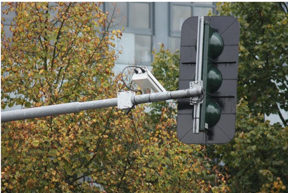
Abbildung 3: Verkehrskamera auf dem Mast einer Lichtsignalanlage
