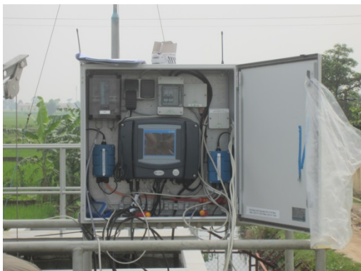
Zentrale Monitoringeinrichtung mit Datenfernübertragung
