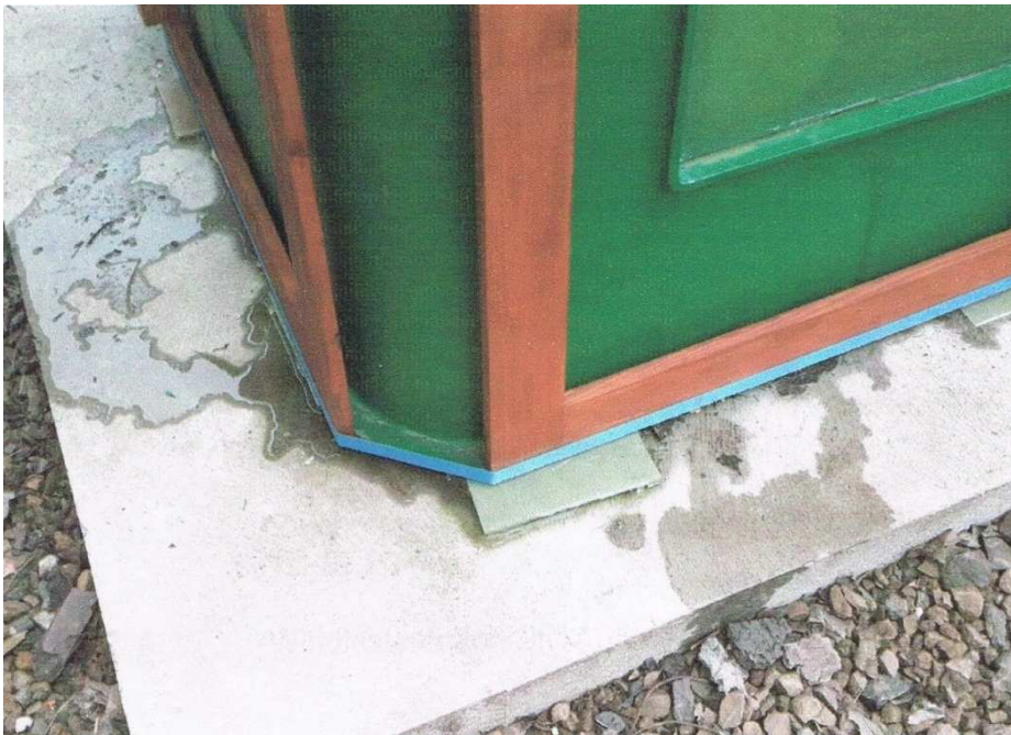
Abb. 4.4 Undichtheiten nach Ersteinbau von V I (2. Septemberhälfte 2014)
