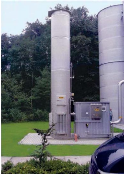
Abbildung 11: Gasfackel einer Biogasanlage [7]
