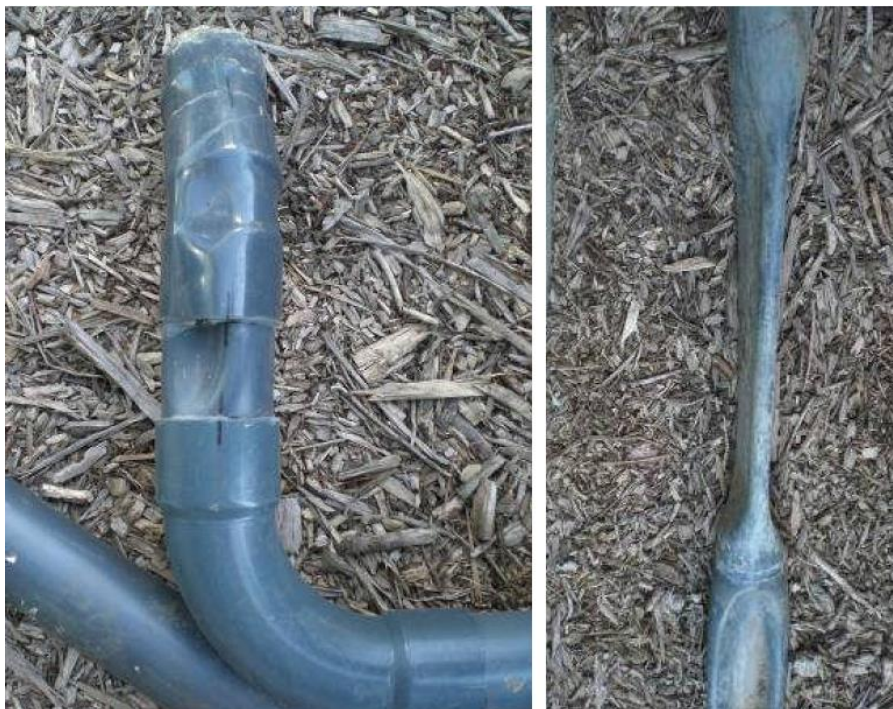
Abbildung 4: Durch Unterdruck verformte Gasleitungen [7]
