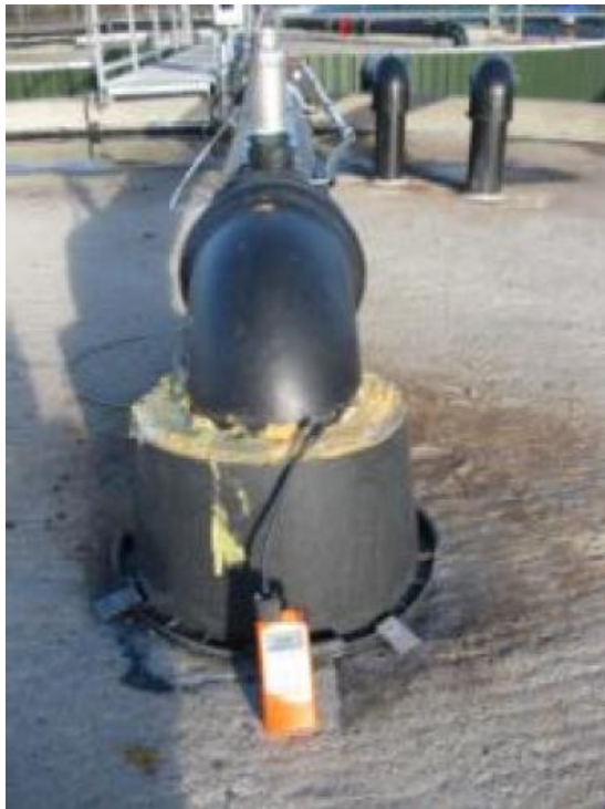
Abbildung 8: Emissionsmessung an notdürftig abgedichteter Gasleitung
