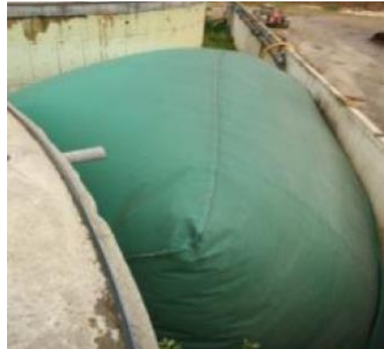
Abbildung 10: Schlecht positioniertes Folienkissen [13]
