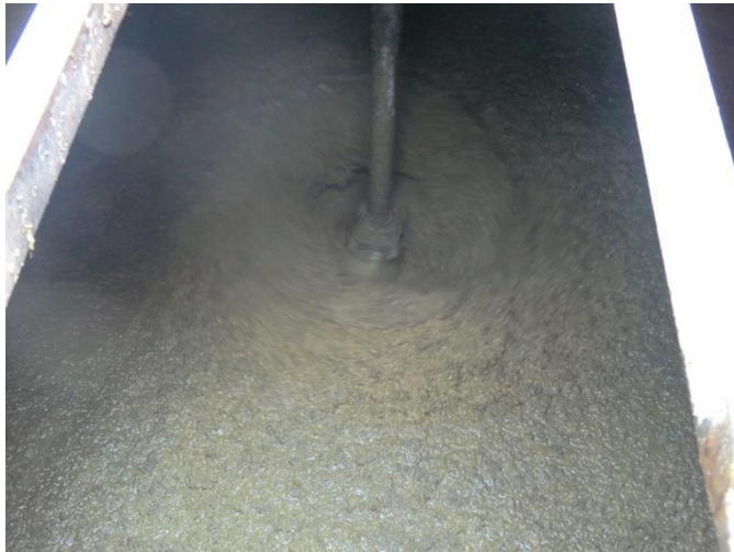
Abbildung 25: Blick in die Hydrolysegrube einer Praxis-Biogasanlage mit zwei-phasiger Verfahrensführung. [Bioreact]
