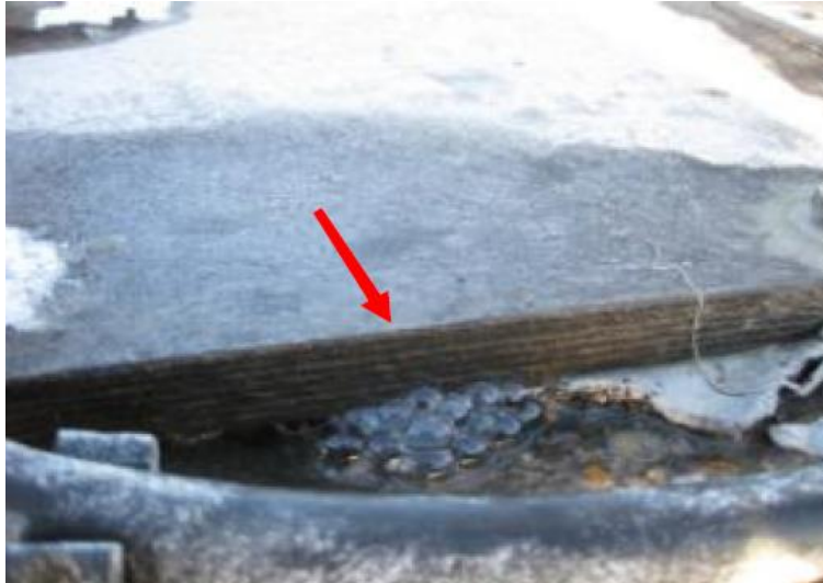
Abbildung 6: Blasenbildung durch defekte Silikonabdichtung einer Revisionsöffnung im Betondach[2]
