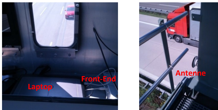
Abbildung 3-2: Installation der Störsenderdetektoren (links) und Antennenposition an der A92 (rechts)
