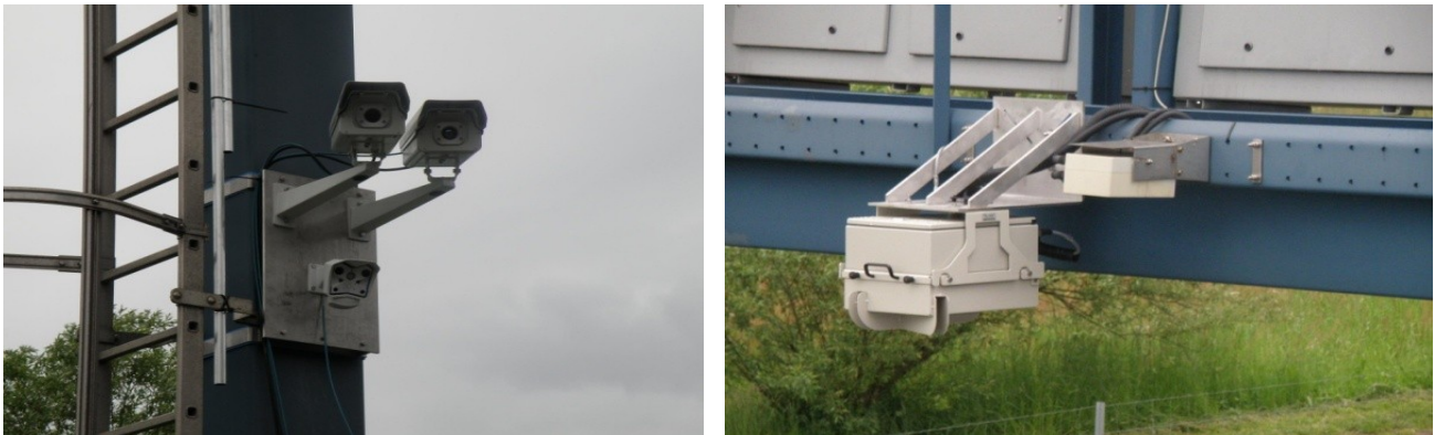
Abbildung 4: links: Infrarot-Kameras (oben), Videokamera (unten), rechts: Laserscannereinheit über der Fahrbahn.
