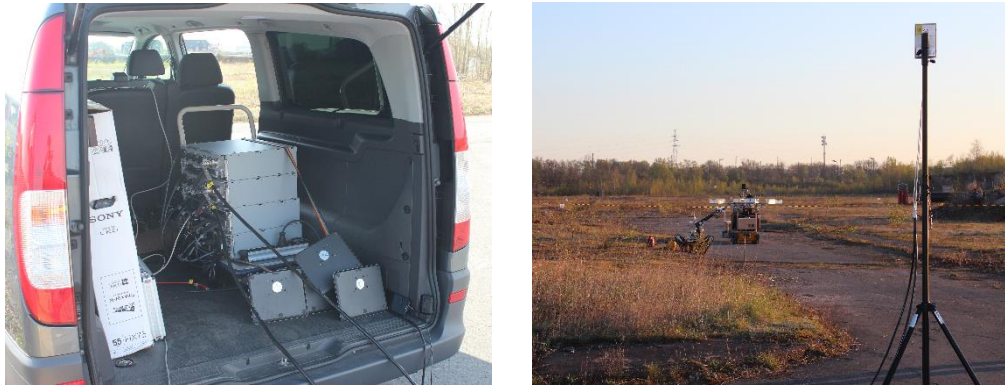
Abbildung 22: Installation von LTE EPC und eNodeB in einem Wagen (links) und eine gerichtete Antenne (rechts) mit Fokus auf den Gefahrenbereich während der Großübung der Feuerwehr (Quelle: TU Dortmund)
