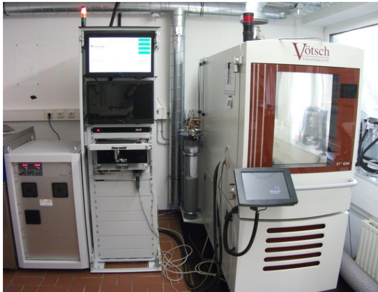
Abbildung 104: Batterieteststand des Fraunhofer IWES
