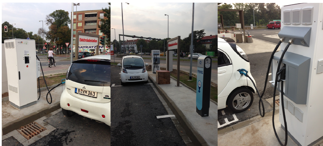
Abbildung 22: Schnell-Ladestation Jaffeestraße mit abgesetztem Terminal
