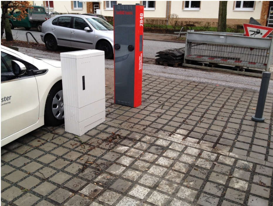
Abbildung 6: Station Rosentreppe - Terminal mit Stromanschlusskasten (Anforderung)
