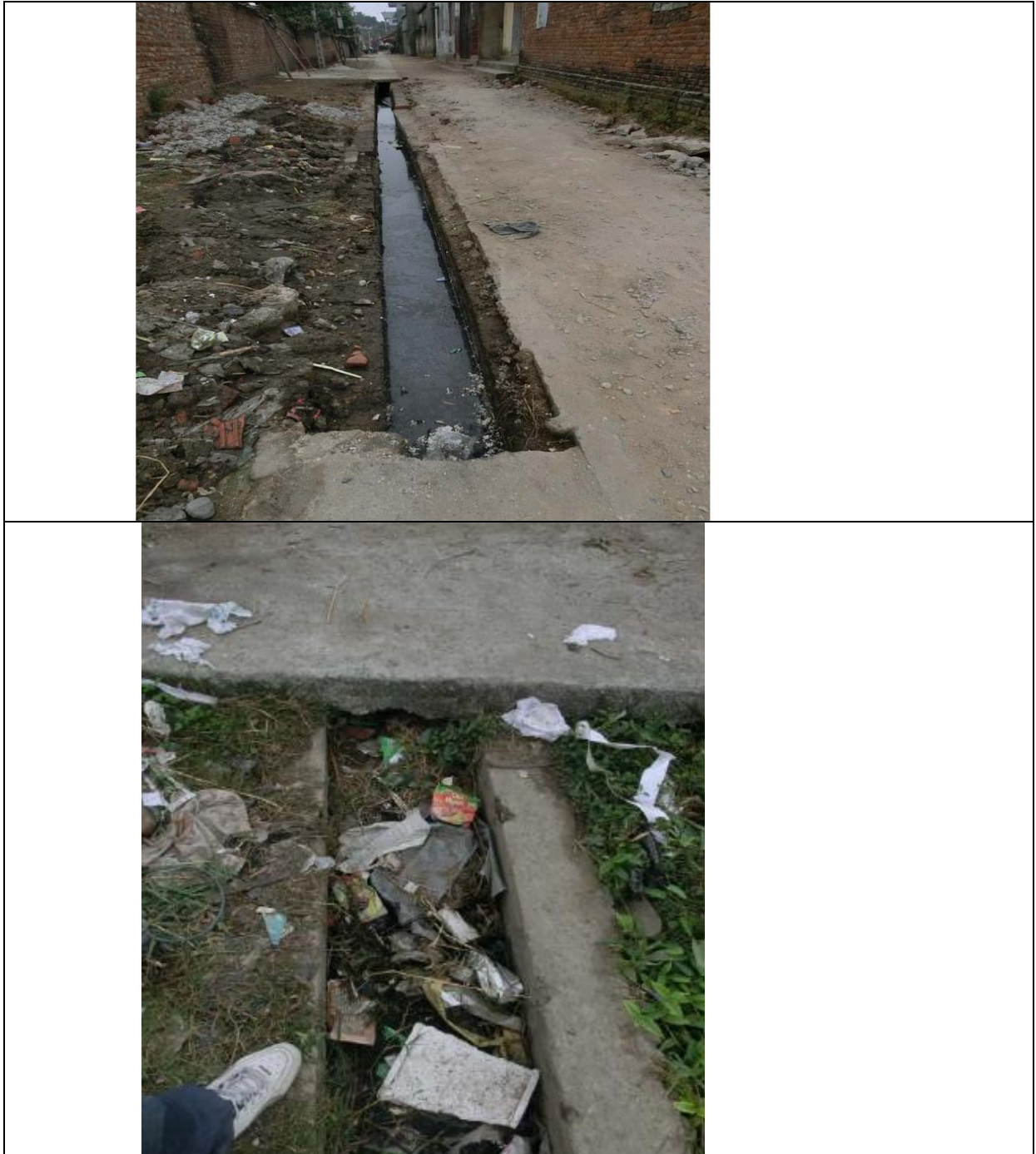
Abbildung 8: zum Teil stark verschmutzte und beschädigte Abwasserkanäle in Dai Lam
