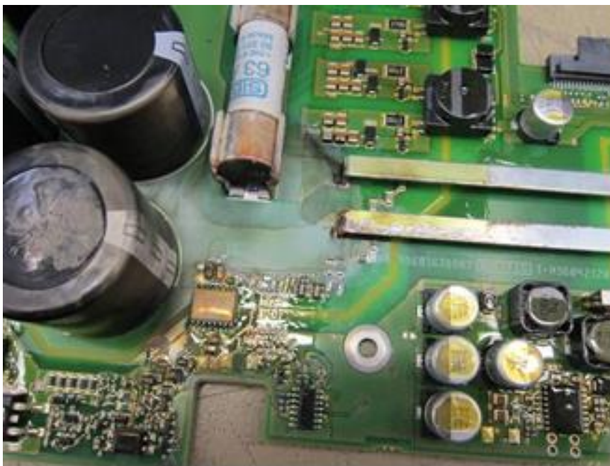
Bild 6-5: Überschlagespuren am Powerboard eines Umrichters
