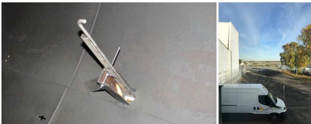
Bild 2: eingebaute Messsonde im Abluftkanal (links); Parkposition Messfahrzeug an der Außenwand des Prüfstands in Höhe des Abluftkanals (rechts).
